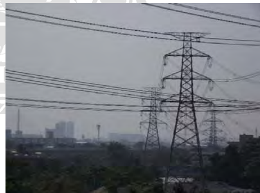
ภาพที่ 2-14 เสาโครงเหล็กในระบบส่ง 230 กิโลโวลต์
