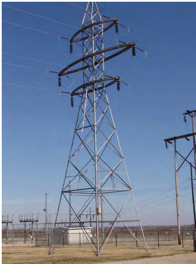
ภาพที่ 2-15 เสาโครงเหล็กในระบบส่ง 115 กิโลโวลต์
