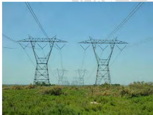
ภาพที่ 2-13 เสาโครงเหล็กในระบบส่ง 500 กิโลโวลต์
