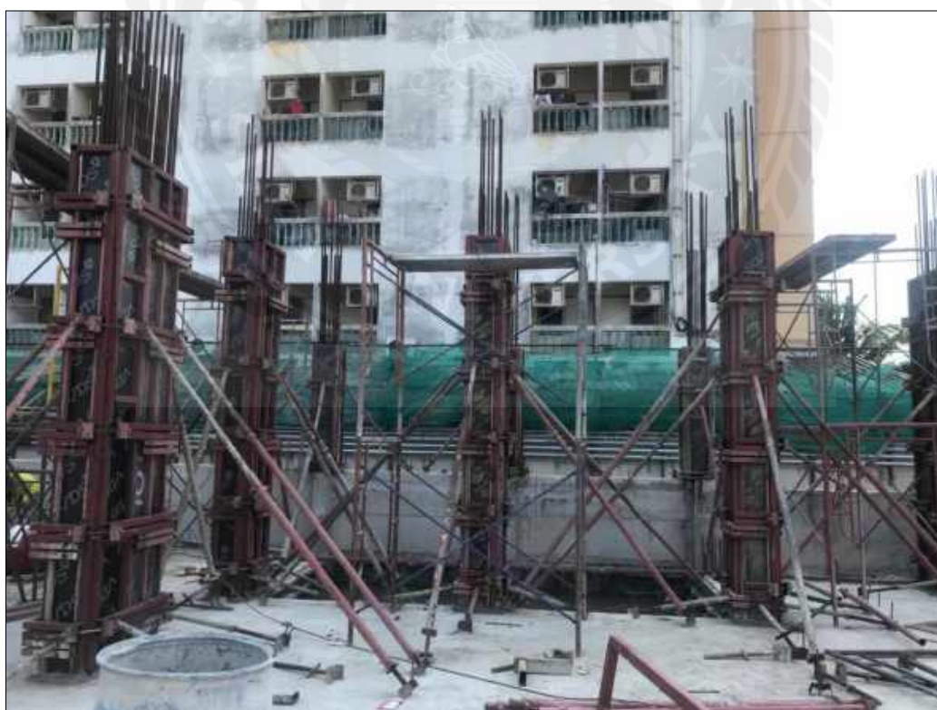
ภาคผนวกรูปที่ 4 ค้ำยันแบบเสา
