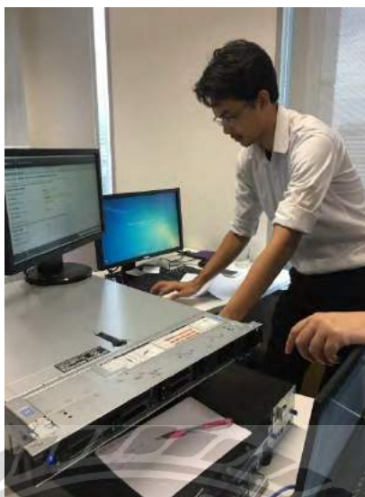
รูปที่ 3 การตรวจสอบข้อมูลก่อนการติดตั้งระบบปฏิบัติการให้กับเครื่องแม่ข่าย
