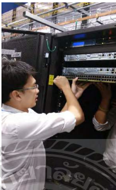
รูปที่ 7 การติดตั้งอุปกรณ์ในระบบเครือข่าย
