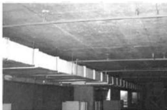
รูปที่ 2.12 ติดตั้งหัวกระจายน้ำดับเพลิงใต้ท่อลม
