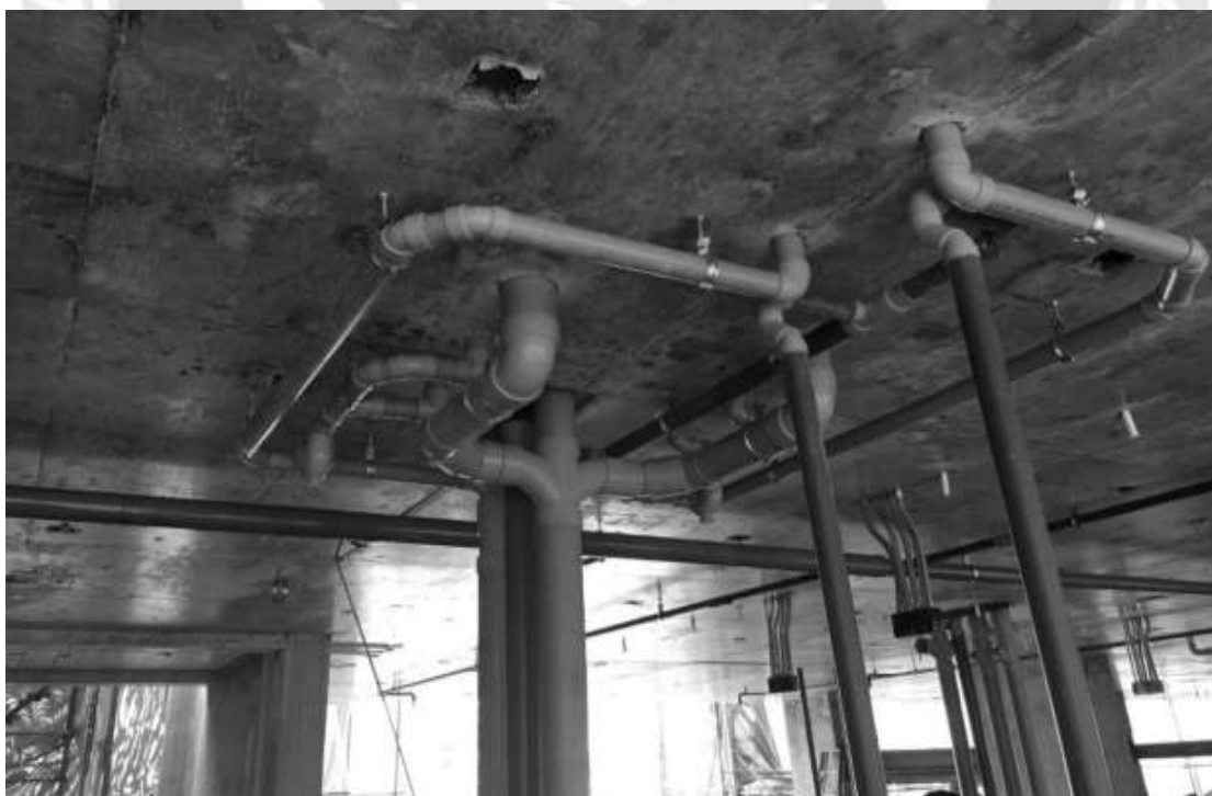
รูปที่ 3.9 การติดตั้งท่อที่ต่อจากท่อเมนหลักของท่อไฮโดรคิก ท่อน้ำทิ้งและท่ออากาศ ห้องคู่ (T04)
