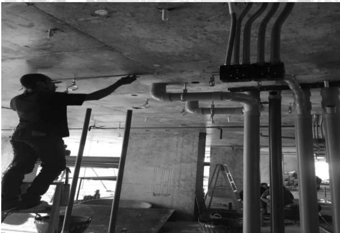
รูปที่ 4 นักศึกษาควบคุมงานการติดตั้งระบบท่อ โสโครก ท่อน้ำทิ้งและท่ออากาศ
