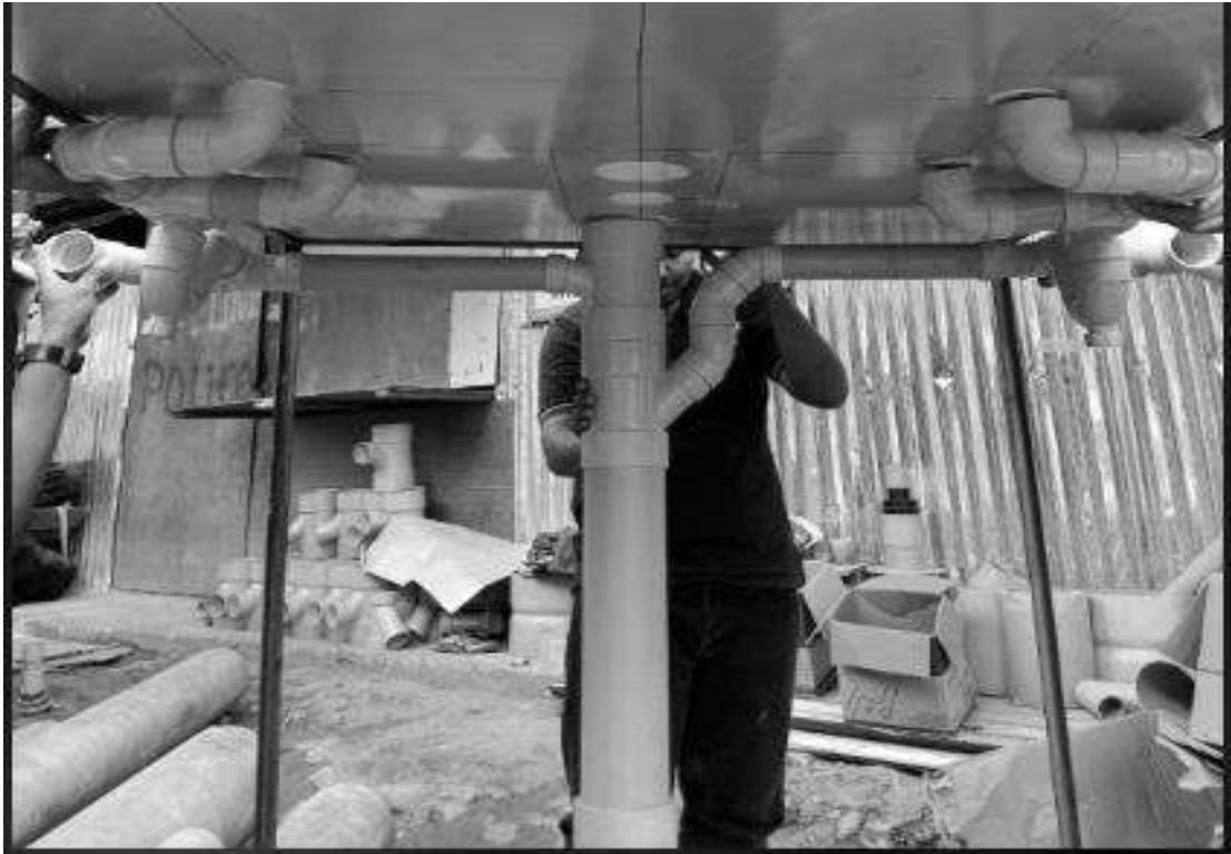
รูปที่ 3.14 การประกอบท่อน้ำทิ้งที่ต่อจากท่อเมนหลัก ห้องคู่ (T04)
