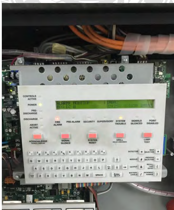
รูปที่ 4.9 ตู้ Fire Alarm Control Panel (FCP) แสดงผลจุดที่ ทดสอบ Smoke Detector
