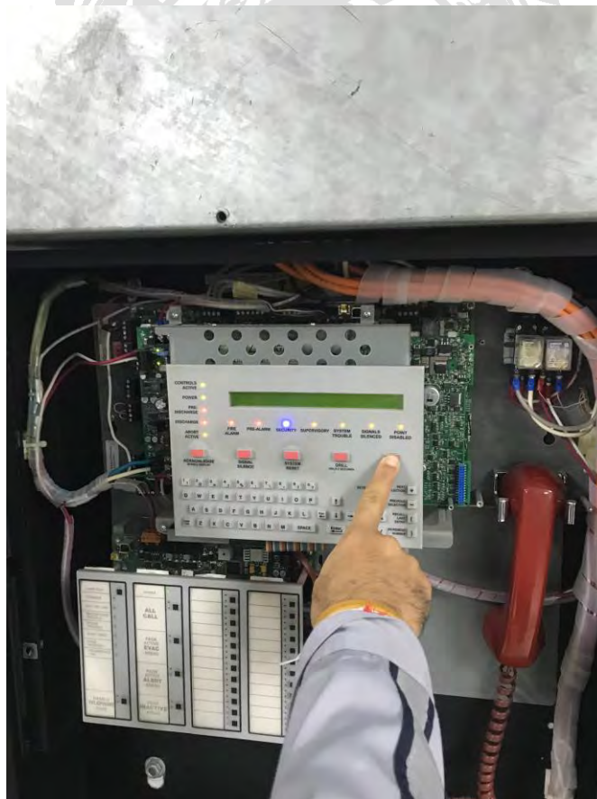
รูปที่ 4.3 Test Lamp Fire Alarm Control Panel (FCP)
