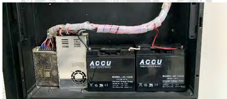
รูปที่ 2.7 ชุดจ่ายไฟ (Power Supply)
