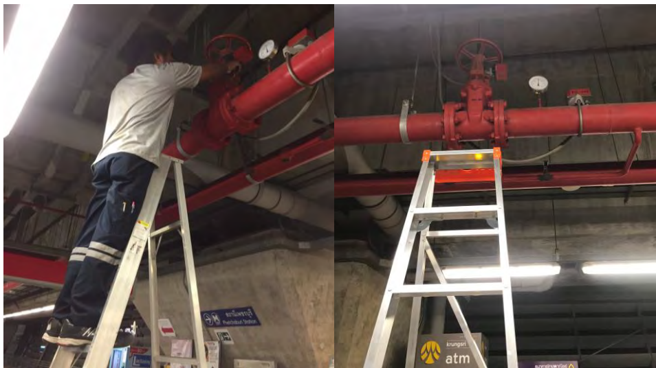
รูปที่ 4.13 อุปกรณ์ตรวจสอบสถานะของวาล์วน้ำ ( Supervisory Switch)
