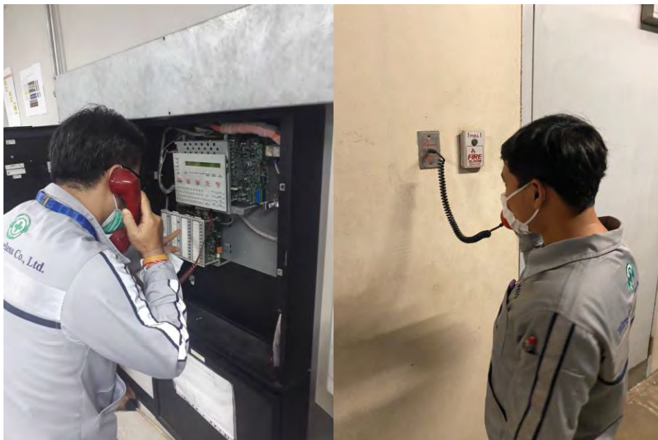
รูปที่ 4.6 ทดสอบความพร้อมใช้งานของ Fireman Call Point
