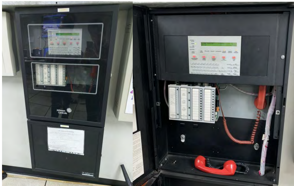
รูปที่ 2.8 ตู้ Fire Alarm Control Panel (FCP)
