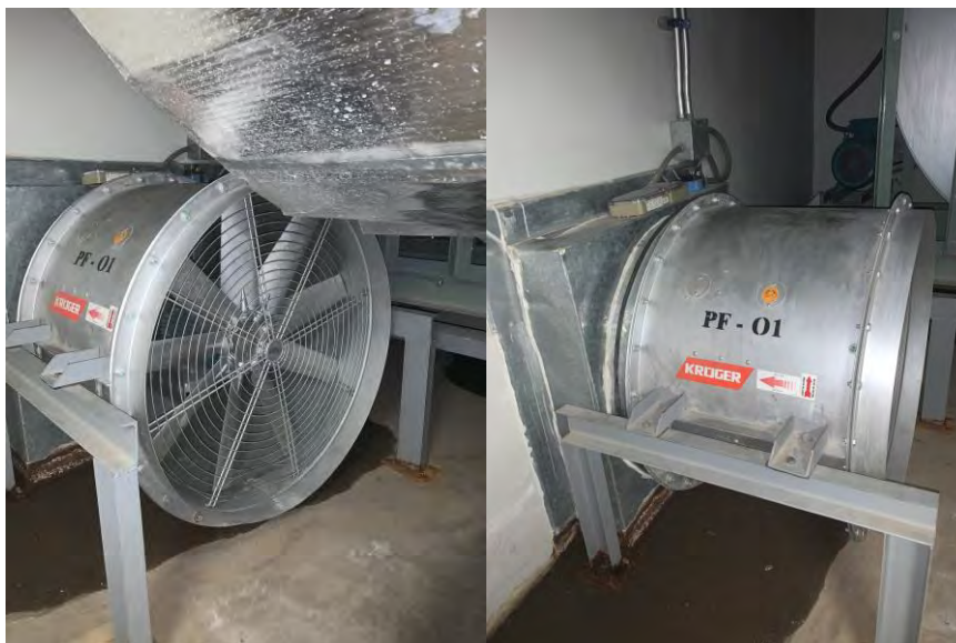
รูปที่ 2.25 พัดลมอัดอากาศบันไดหนีไฟ (Pressurized Fan )
