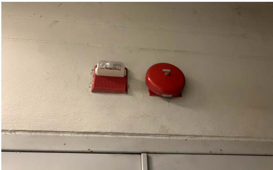
รูปที่ 4.11 อุปกรณ์แจ้งสัญญาณด้วยแสงและเสียง 4.2.9 ตรวจสอบสถานะของอุปกรณ์ตรวจสอบน้ำไหล ( Water Flow switch )
