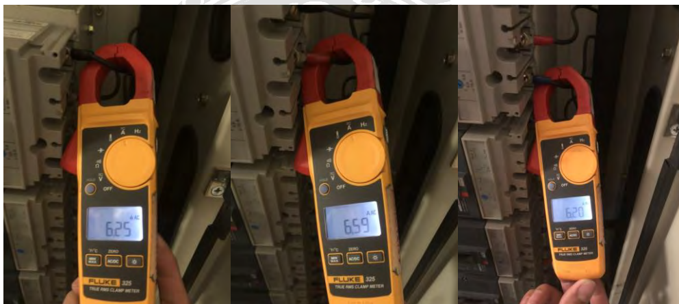
รูปที่ 4.19 ตรวจสอบวัดกระแสขณะ Smoke Extract Fan ทำงาน
