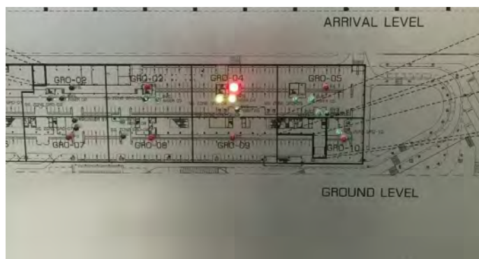
รูปที่ 4.15 ตู้ Graphic Annunciator แสดงผลจุดที่ สถานะของวาล์วน้ำ ( Supervisory Switch) และ อุปกรณ์ตรวจสอบน้ำไหล ( Water Flow switch )
