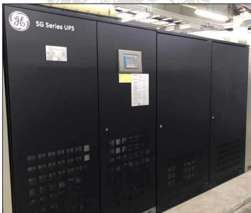
รูปที่ 4.8 เครื่องสำรองไฟฟ้า UPS
