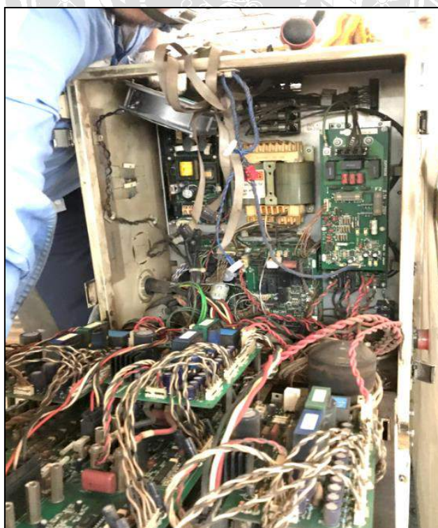
รูปที่ 4.12 ทำความสะอาดตู้ควบคุมหุ่นยนต์เชื่อม
