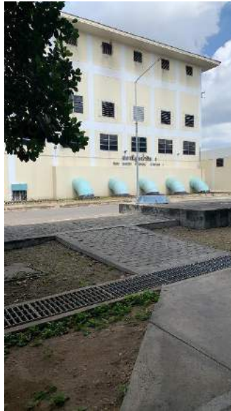
รูปที่ 3 สถานีสูบน้ำดิบ
