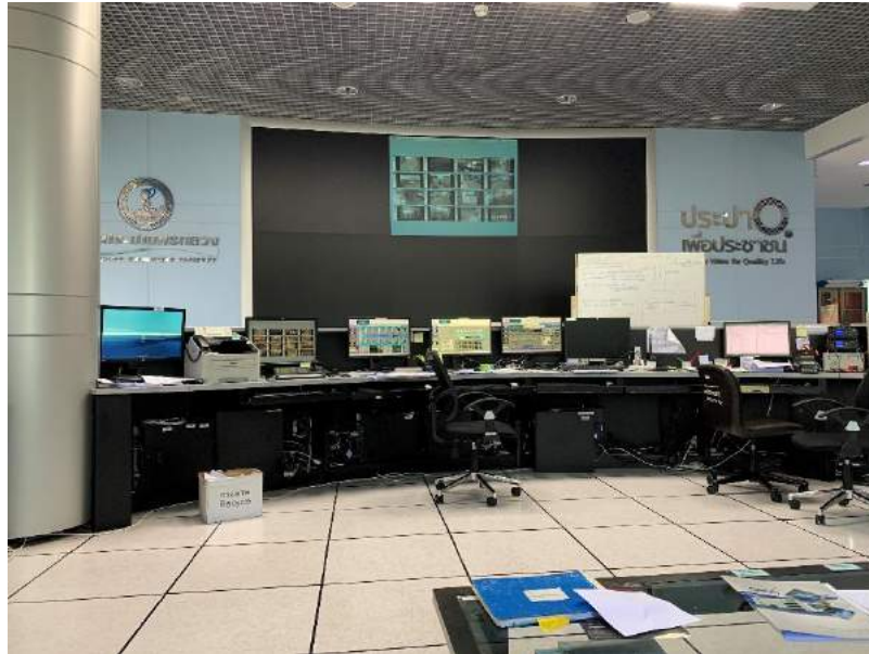
รูปที่ 1 ห้องควบคุม
