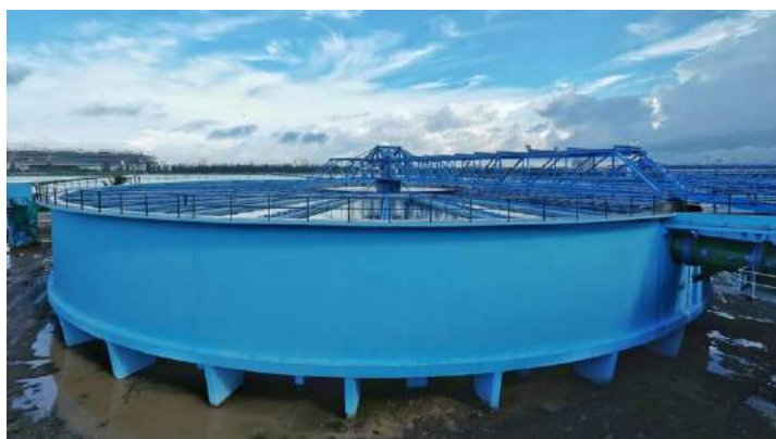
รูปที่ 3.14 ถังตกตะกอน (Solid Contact Clarifier)[2]
