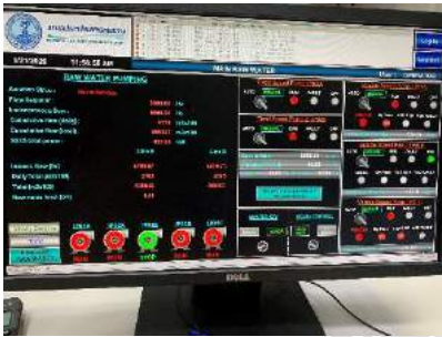
รูปที่ 2 หน้าจอห้องควบคุม
