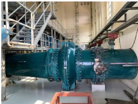
รูปที่ 5 ปั๊มสูบน้ำดิบ
