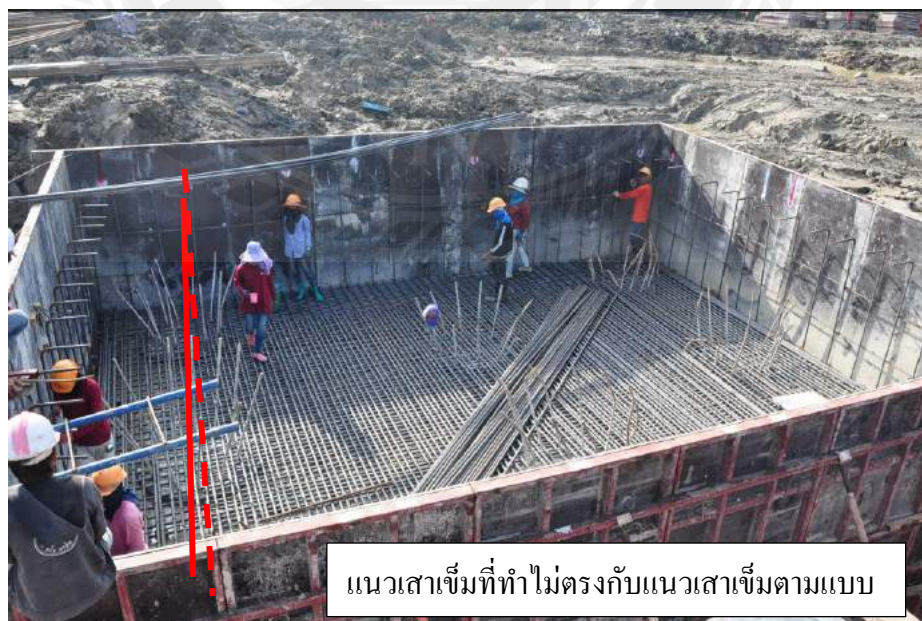
ภาพที่ 1.2. เสาเข็มเสียศูนย์ในหน้างานก่อสร้าง
