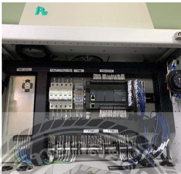
รูปที่ 4.3 PLC ที่ใช้ในการควบคุมการทำงานของตู้ควบคุมในระบบบำบัดน้ำเสีย
