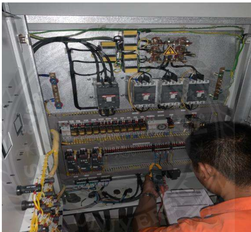
รูปที่ 3.19 ตรวจสอบการทำงานของระบบ Submerable Pump (ห้อง Fire Pump)
