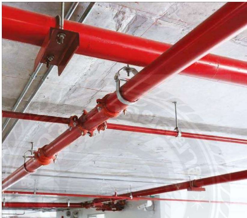
รูปที่ 2.2 ท่อระบบดับเพลิง
