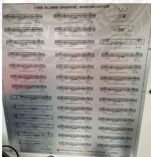
รูปที่ 3.7 ตรวจสอบหลอดไฟแจ้งเตือน Alarm ที่ตู้ Graphic Alarm
