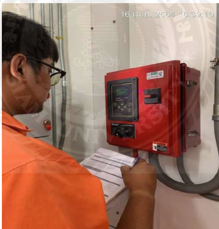
รูปที่ 3.12 การตรวจสอบระบบเครื่องสูบน้ำดับเพลิง (Jockey Pump)
