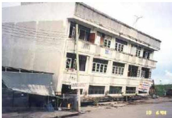
รูปที่ 2-1 อาคารที่เกิดการทรุดตัวจนใช้งานไม่ได้แต่โครงสร้างอาคารไม่เกิดการวิบัติ (ภาพจากเว็บไซต์ของ วิศวกรรมสถานแห่งประเทศไทยฯ)
