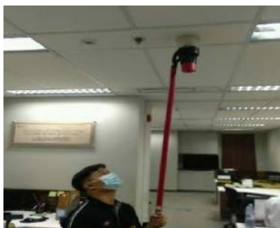
รูปที่ 4.5 การทดสอบอุปกรณ์ตรวจจับควัน
