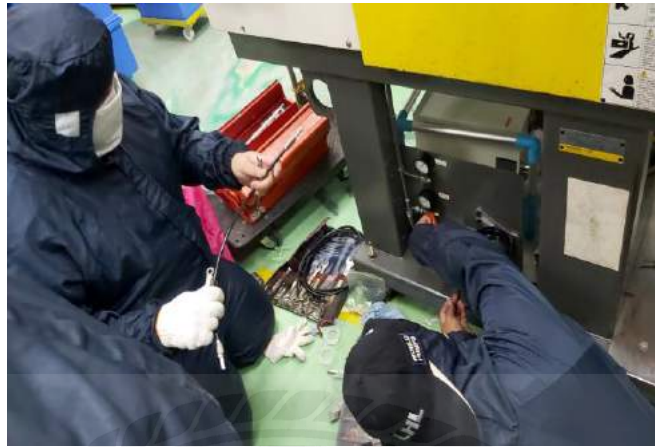
รูปที่ 4.4 ติดตั้งอุปกรณ์ตู้คอนโทรล ระบบน้ำมันอัตโนมัติ
