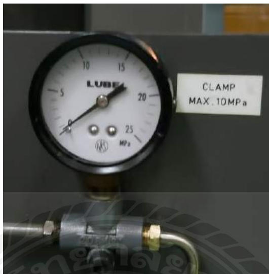
รูปที่ 4.17 Pressure Gauge.
