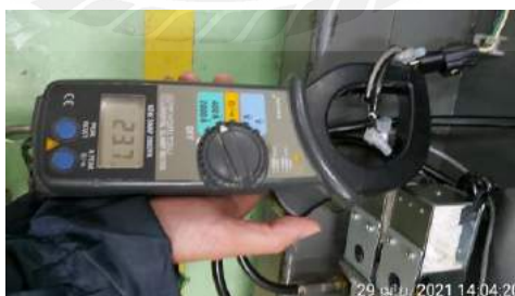
รูปที่ 4.23 เก็บค่าพลังงานไฟฟ้าของทั้งสองระบบโดยใช้ Clamp meter
