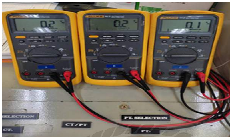
รูปที่ 4.24 ตรวจเช็คมิตเตอร์ให้อยู่ใน VAC ที่ Range 600 v.
