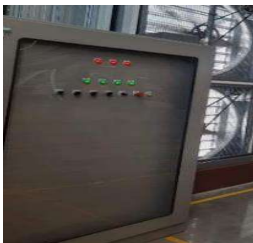
รูปที่ 2.9 ตู้ควบคุมเปิด-ปิดพัดลม
