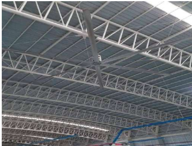
รูปที่ 4.16 พัฒนาระบบระบายอากาศ
