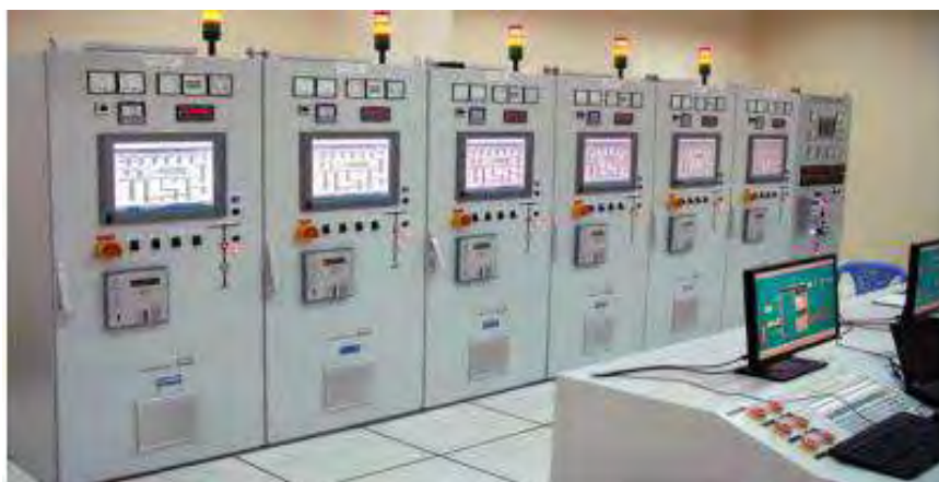
รูปที่ 2.3 ตู้ควบคุมระบบไฟฟ้า
