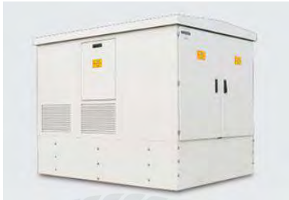
รูปที่ 2.8 Unit Substation
