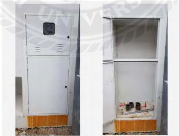
รูปที่ 2.9 ตู้มิเตอร์ LV (WL001)
