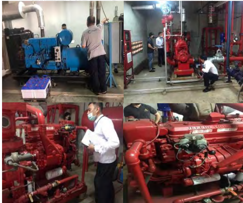
รูปที่ 4.12 เซ็กระบบปั้มน้ำในอาคาร (อพาร์ทเมนท์เทพประทาน)
