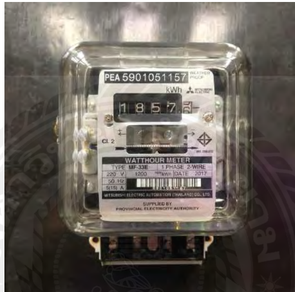
รูปที่ 2.9 มิเตอร์ 1 เฟส 2 สาย ชนิดจานหมุน
