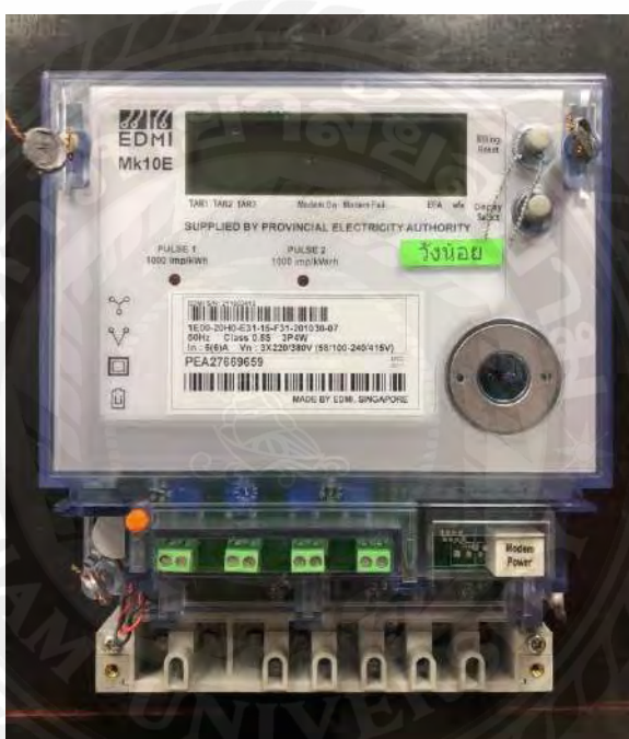
รูปที่ 2.16 มิเตอร์ 3 เฟส 4 สาย ประกอบด้วย ซีที แรงต่ำ ทีโอยู
