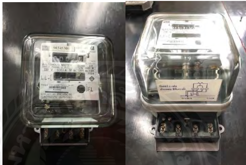
รูปที่ 2.11 มิเตอร์ 1 เฟส 2 สาย ประกอบ ซีที แรงต่ำ ชนิดจานหมุน
