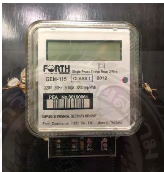
รูปที่ 2.10 มิเตอร์ 1 เฟส 2 สาย ชนิดอิเล็กทรอนิกส์
