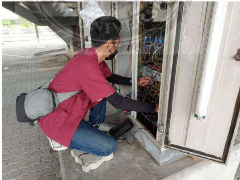
รูปที่ 4.9 ตรวจสอบกระแสไฟฟ้า
