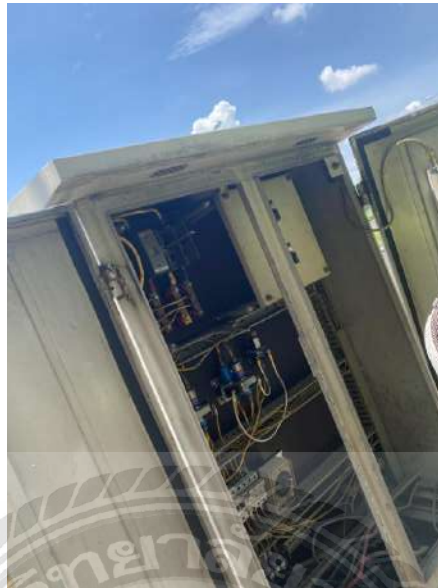
รูปที่ 4.10 ทำความสะดวกตู้ควบคุมไฟฟ้า
