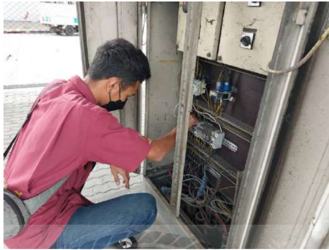
รูปที่ 4.8 แก้ไขเบรกเกอร์กันดูด 30 แอมป์ โดยการเปลี่ยนใหม่
