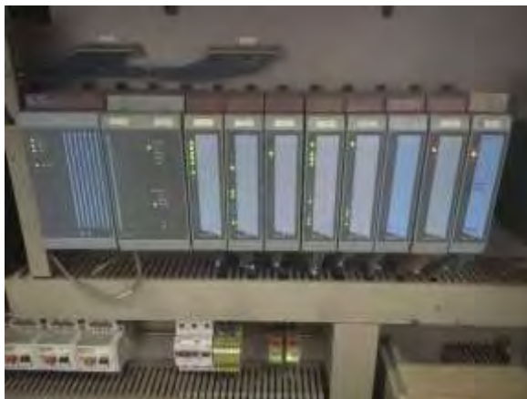
รูปที่ 4.4 PLC
