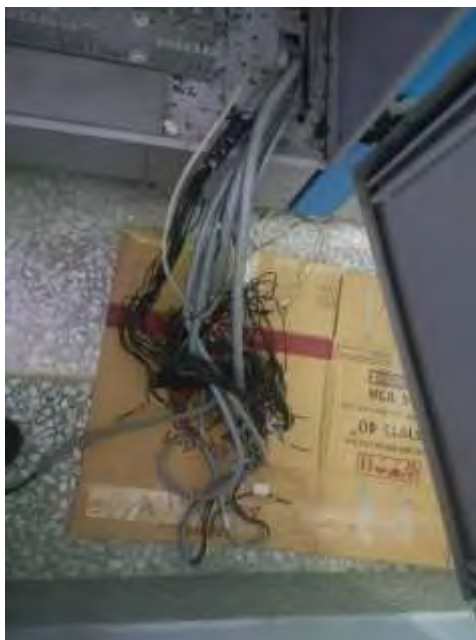
รูปที่ 4.41 สายไฟจากอุปกรณ์ของส่วนต่างๆของเครื่องมาต่อกับตู้ควบคุม
