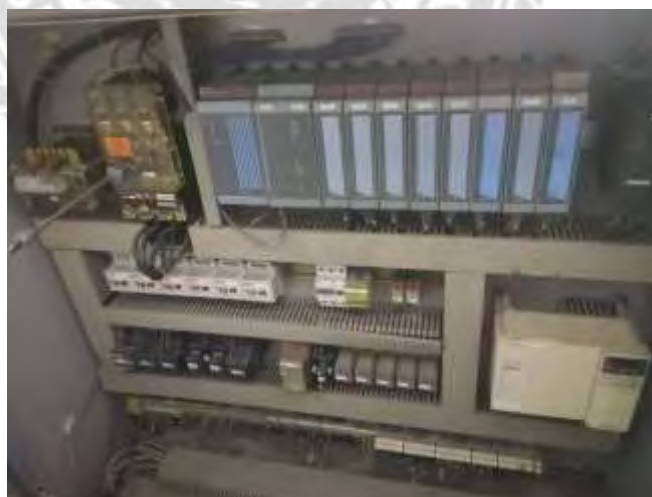
รูปที่ 4.3 อุปกรณ์ต่างๆภายในตู้ควบคุม
