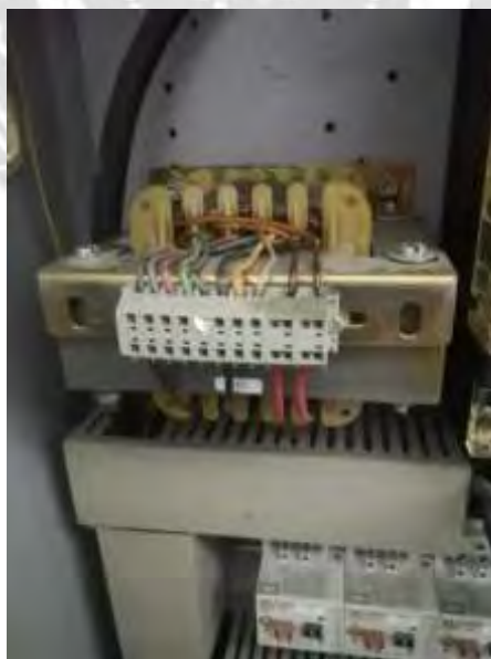
รูปที่ 4.13 หม้อแปลง
