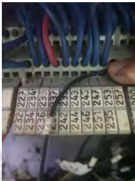
รูปที่ 4.43 รูปของการเชื่อมต่อสายไฟตามหมายเลขกับเต้าต่อสายไฟในตู้คุมไฟ
