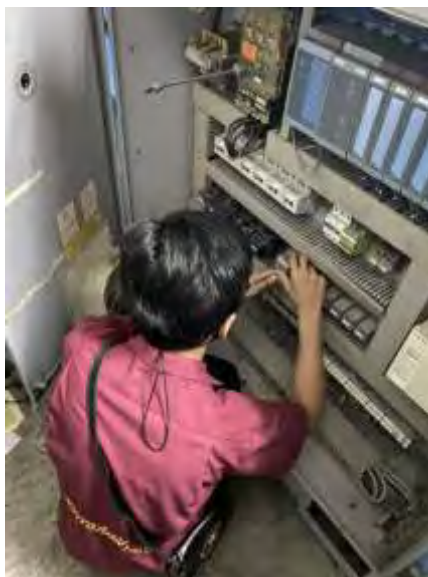
รูปที่ 4.47 ติดตั้งอุปกรณ์ไฟฟ้าให้กับเครื่องเย็บสันหนังสือ
