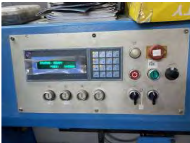
รูปที่ 4.22 แผงควบคุม
