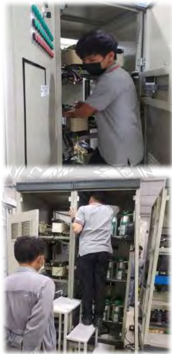
รูปที่ 4.11 การตรวจสอบการเข้าสายไฟฟ้าของชุดคาปาซิเตอร์
