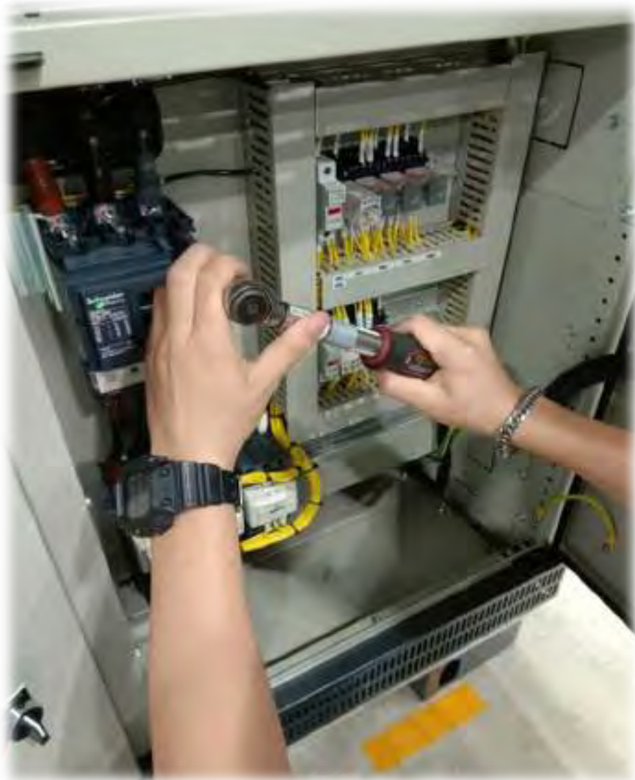
รูปที่ 4.6 การเช็คทอร์คจุดต่อสาย
