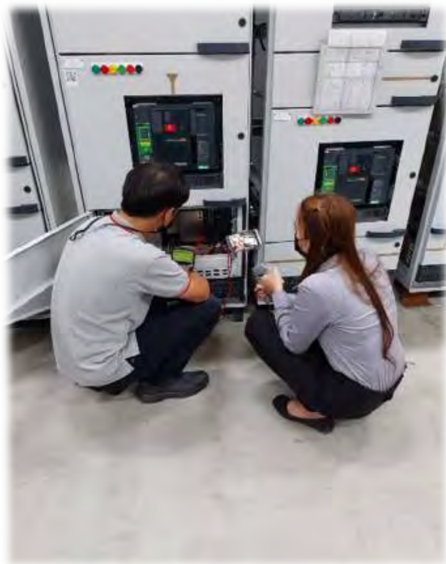
รูปที่ 4.5 การทดสอบความเป็นฉนวน (Insulation Tester)
