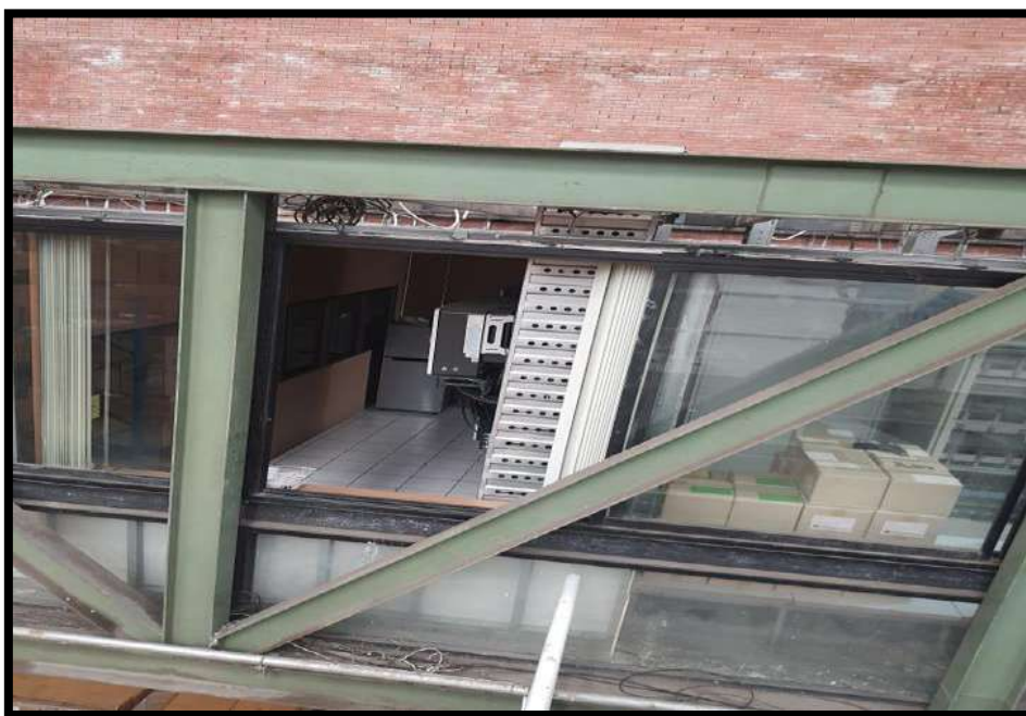
รูปที่ 3.13 เดินรางไฟร้อยสาย AC 3 เฟส
