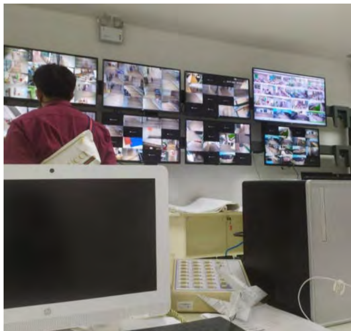
รูปที่ 4.10 การตรวจดูการทำงานระบบปรับอากาศผ่านระบบกล้องโทรทัศน์วงจรปิด
