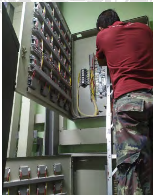
รูปที่ 4.3 การตรวจสอบและแก้ไขอุปกรณ์ไฟฟ้าที่เสื่อมสภาพ
