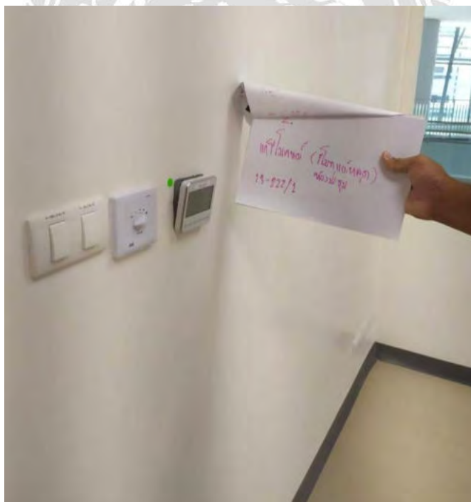
รูปที่ 4.1 สภาพเครื่องควบคุมอุณหภูมิการปรับอากาศที่ชำรุด
