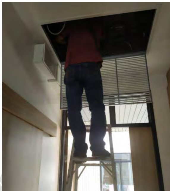
รูปที่ 4.6 การตรวจสอบชุด FCU ของเครื่องปรับอากาศ
