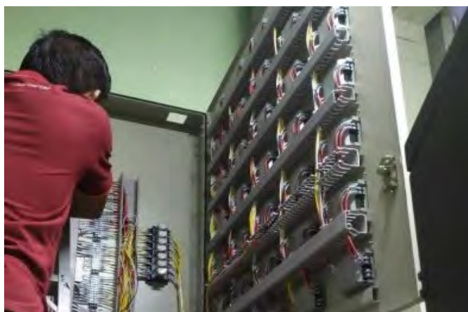
รูปที่ 4.5 การทำความสะอาดอุปกรณ์ ขั้วหลักต่อกระแสไฟฟ้า
