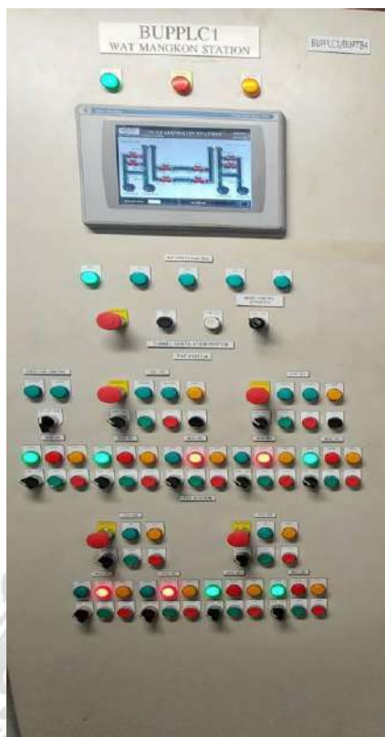
รูปที่ 2.7 หน้าตู้ควบคุมระบบระบายอากาศในอุโมงค์ (VCP)
