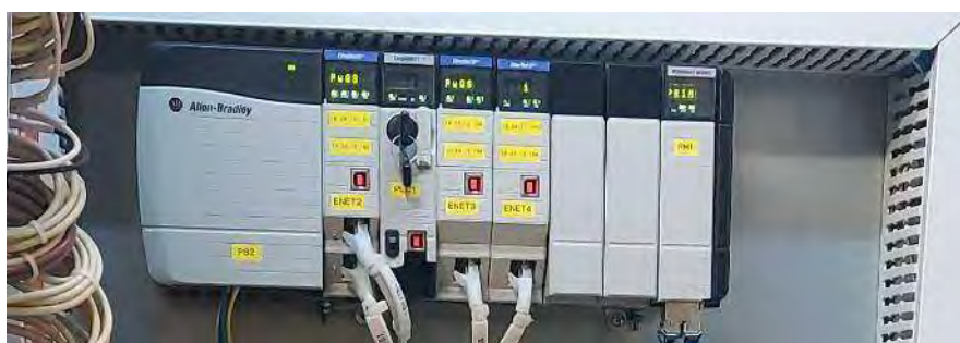
รูปที่ 2.3 หน่วยควบคุม PLC
