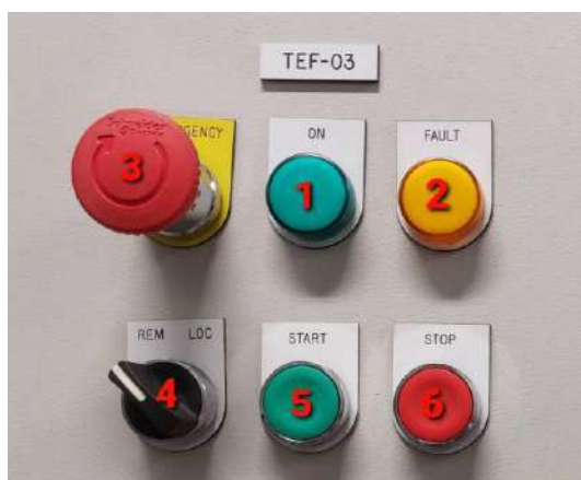
รูปที่ 2.14 สวิตช์เลือกแนวเส้นทางเดินลม (Track way Exhaust Fan: TEF)
