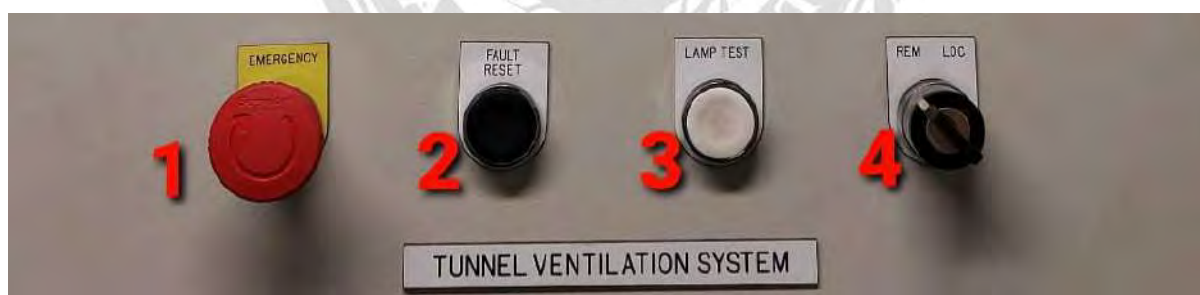
รูปที่ 2.10 แผงควบคุมพัดลมระบายอากาศ
