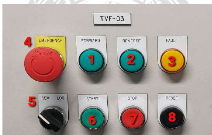
รูปที่ 2.11 Tunnel Ventilation Fan-TVF
