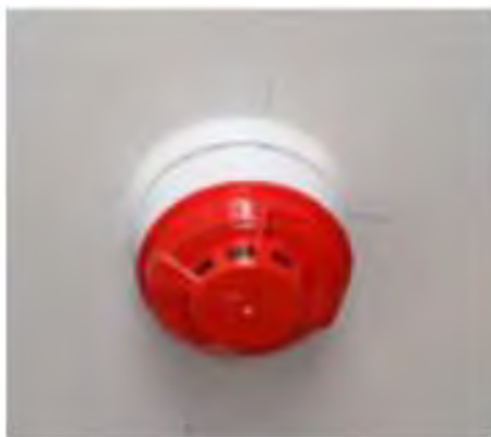
รูปที่ 4.35 อุปกรณ์ตรวจจับควัน (Smoke Detector)
