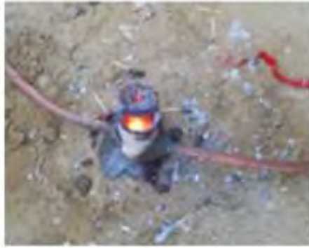
รูปที่ 4.28 การต่อหลักดินด้วยชุดเบ้าหลอมหลักดิน (Exothermic Welding)
