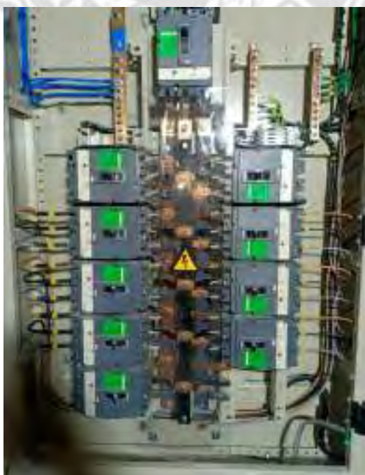
รูปที่ 4.16 แผงไฟฟ้าย่อย
