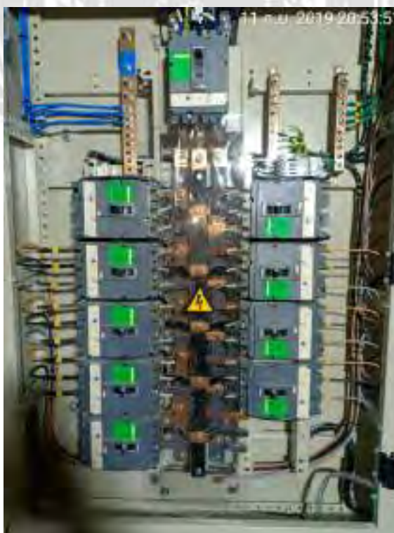
รูปที่ 3.2 แผงไฟฟ้าขนาดย่อย DB
