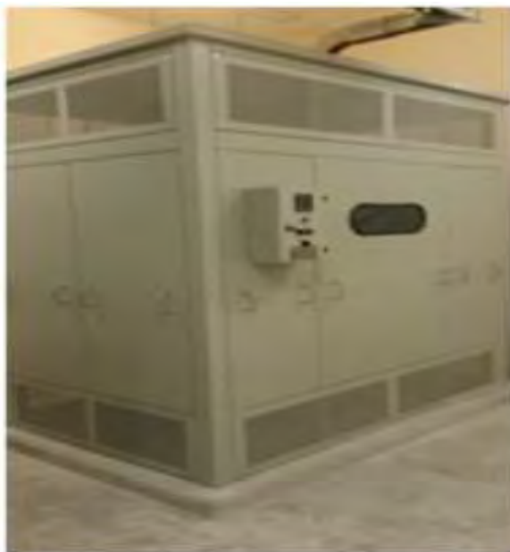
รูปที่ 4.5 หม้อแปลงไฟฟ้า
