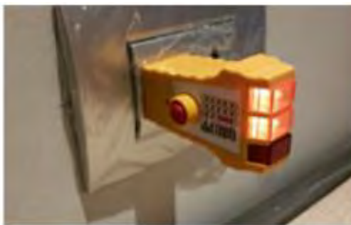
รูปที่ 4.26 อุปกรณ์ทดสอบเต้ารับไฟฟ้า (Easy Check Outlet)
