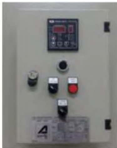
รูปที่ 4.7 ชุดควบคุมการทำงานของหม้อแปลง
