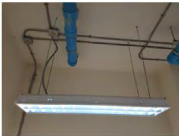
รูปที่ 4.19 การติดตั้งโคมตะแกรง (Fin Louver Type)
