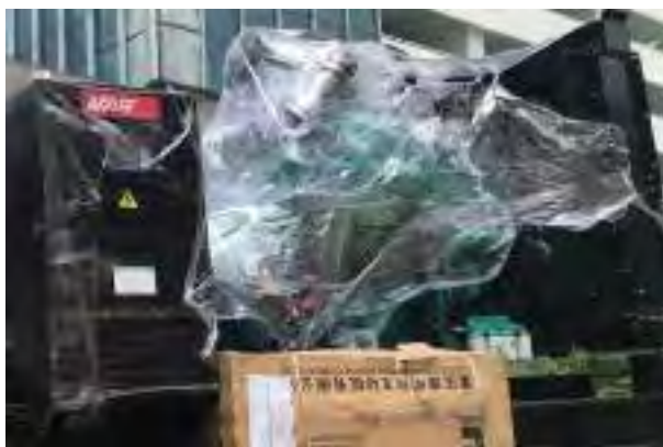
รูปที่ 4.14 เครื่องกำเนิดไฟฟ้า (Generator)
