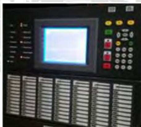
รูปที่ 4.30 แผงควบคุม
