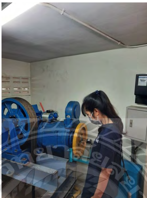
รูปที่ 4.7 การตรวจสอบมอเตอร์เกียร์
