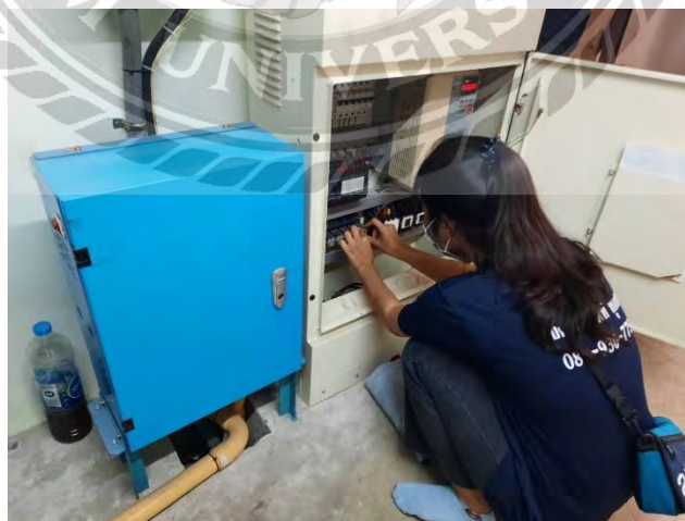
รูปที่ 4.8 การตรวจสอบตู้คอนโทรล
