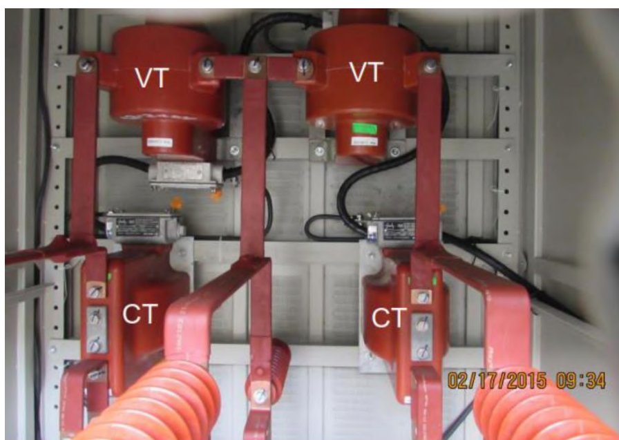
รูปที่ 2.14 รูป CT และ PT(VT) ภายนอก
