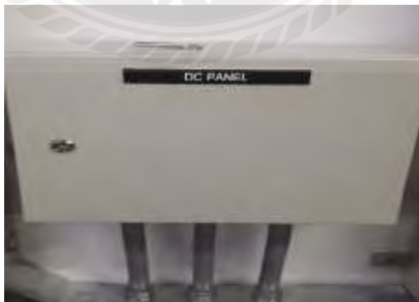
รูปที่ 2.17 ตู้ DC Panel
