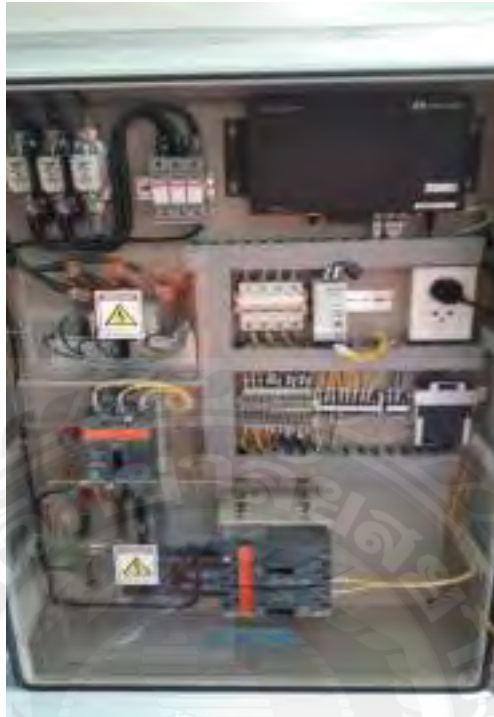
รูปที่ 2.18 ภายในตู้ PV-DB
