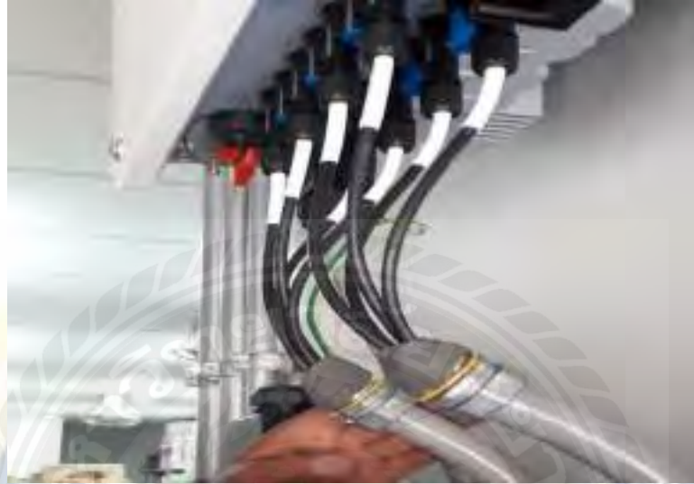
รูปที่ 4.19 ต่อสายจากตู้ DC-PANEL เข้าอินเวอร์เตอร์
