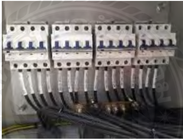
รูปที่ 2.16 ภายในตู้ DC Panel
