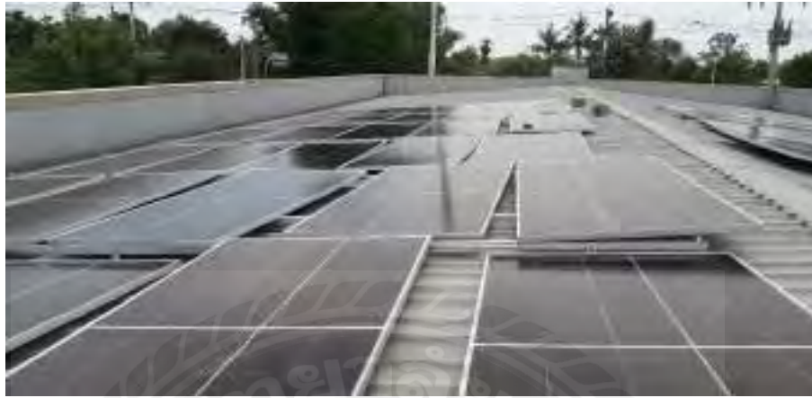
รูปที่ 4.14 การวางแผงโซลาร์เซลล์เตรียมก่อนติดตั้ง
