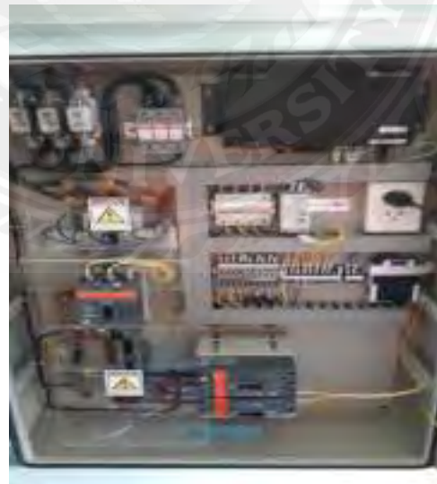
รูปที่ 4.22 ส่วนประกอบภายในตู้ PV-DB
