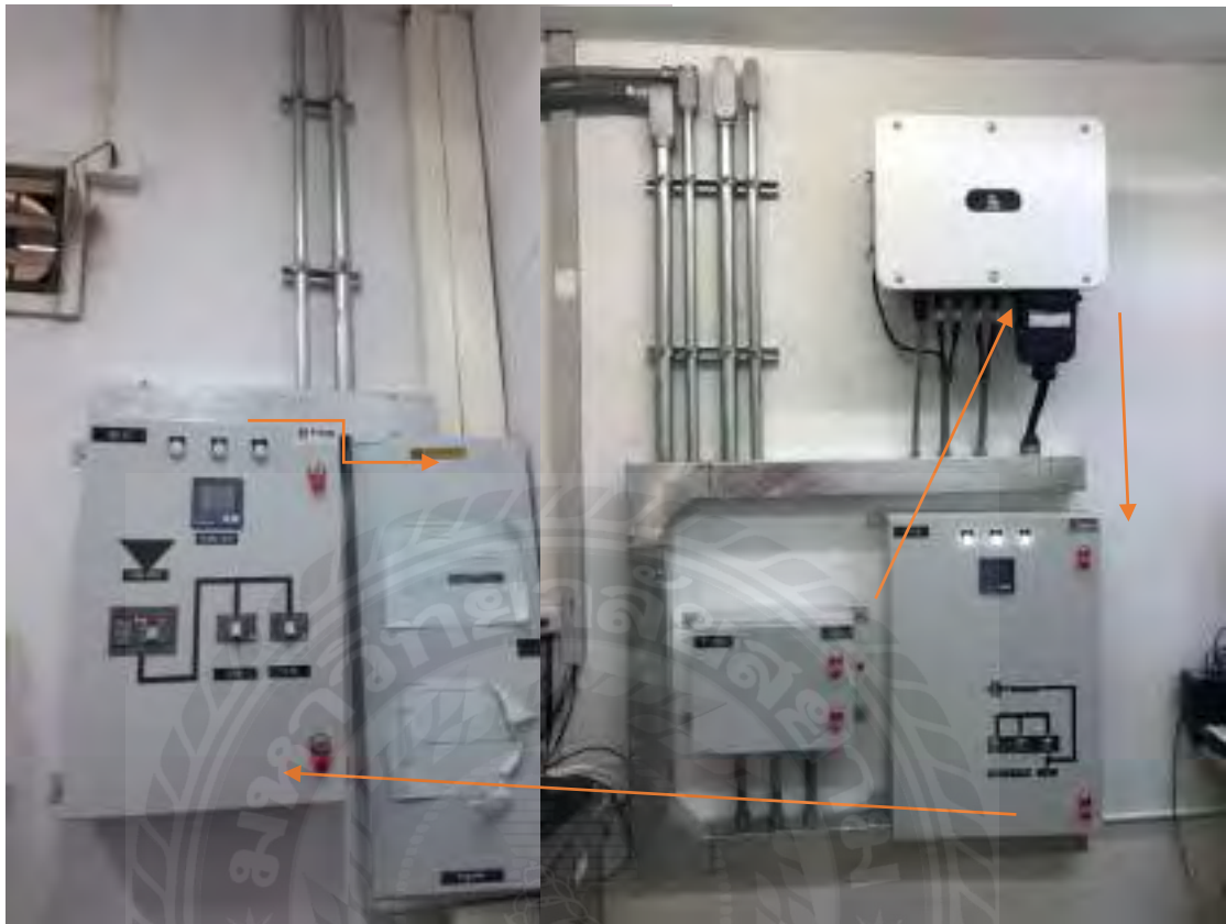
รูปที่ 2.22 ภาพรวมภายในของการติดตั้งตู้ไฟฟ้าและอุปกรณ์ภายในอาคาร
