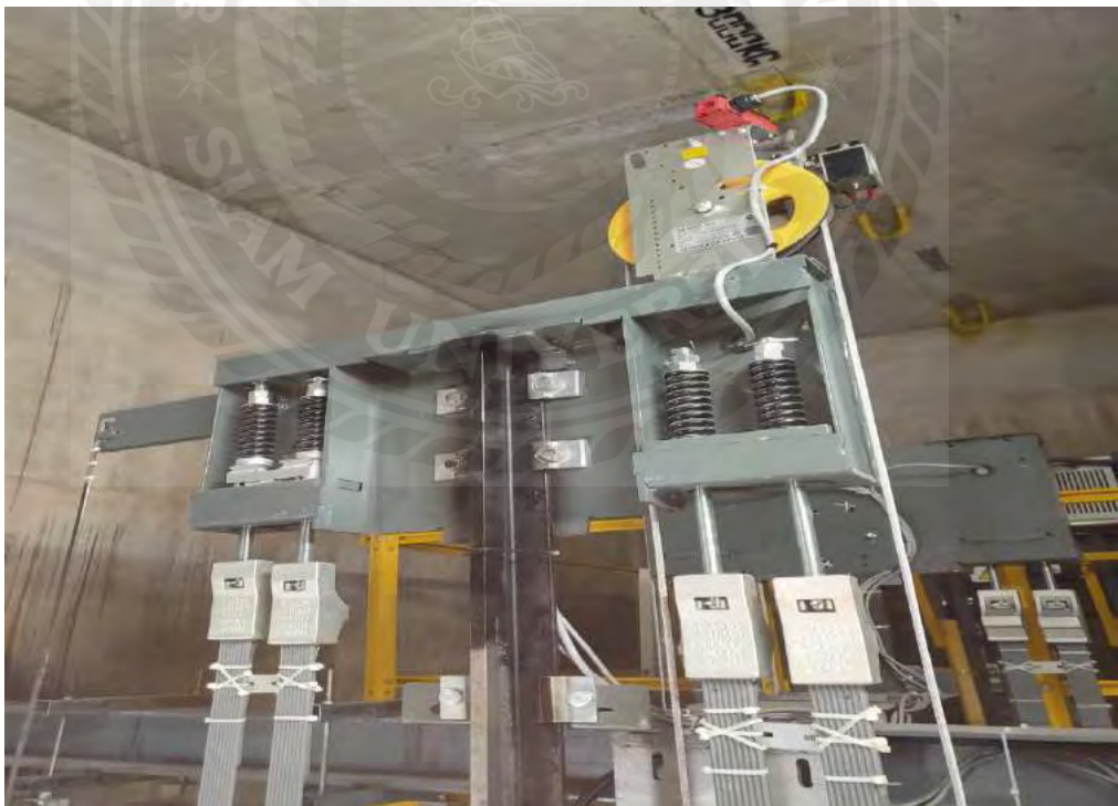
รูปที่ 2.9 ชุดสลิงโกวาเนอร์และคอนแทกหัวสายพานลิฟต์
