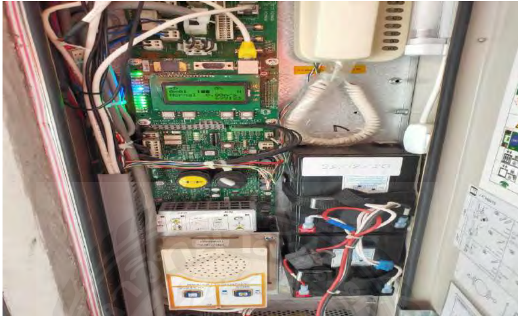
รูปที่ 2.6 ตู้คอนโทรลลิฟต์ (Lift control)
