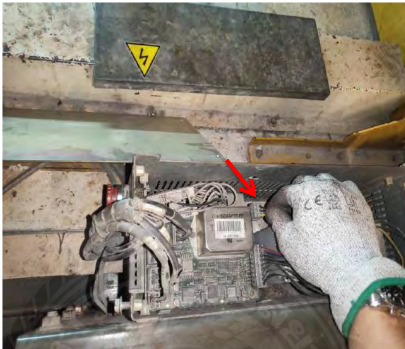
รูปที่ 3.21 ถอด Socket ปลั๊กมอเตอร์เพื่อตัดกระแสไฟฟ้ามอเตอร์ออก
