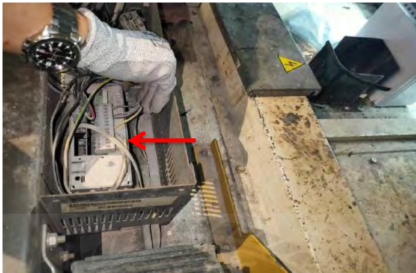
รูปที่ 3.30(A) ถอดSocket ปลั๊กมอเตอร์เพื่อตัดกระแสไฟฟ้ามอเตอร์ออก
