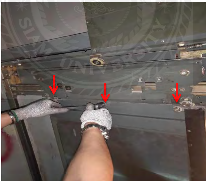
รูปที่ 3.9 การถอดน็อตจุดยึดบานประตูทั้ง 3 จุด
