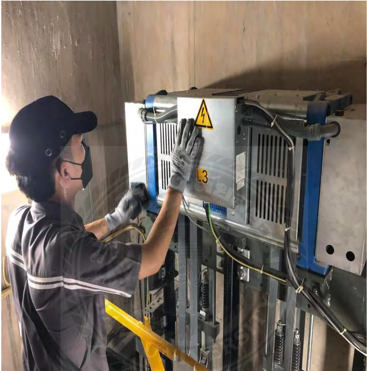
รูปที่ 2 การตรวจเช็คสภาพมอเตอร์ขับเคลื่อนลิฟต์
