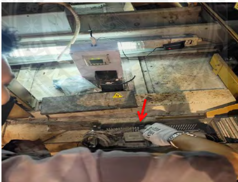
รูปที่ 3.31(B) ถอดSocket ปลั๊กมอเตอร์เพื่อตัดกระแสไฟฟ้ามอเตอร์ออก
