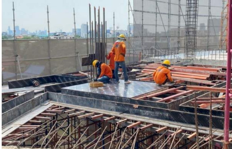
รูปที่ 4.8 การติดตั้งไม้แบบรองรับน้ำหนักคอนกรีตและคาน
