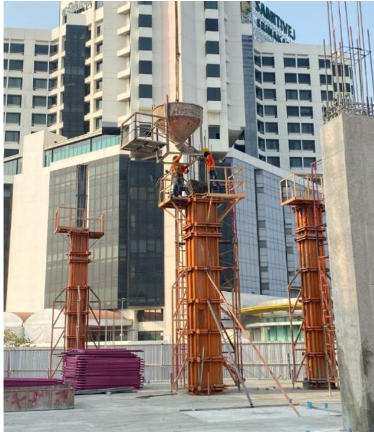
รูปที่ 4.18 การใช้ Tower Crane ยกฟ็อกเก็ตปูนเทเสาคอนกรีต
