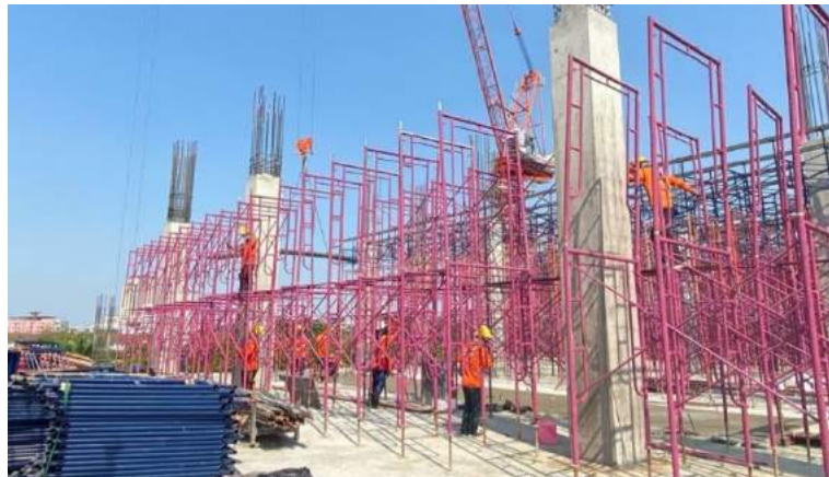
รูปที่ 4.4 การติดตั้งนั่งร้านรองรับน้ำหนักพื้น
