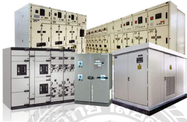
รูปที่ 3.3 สวิตช์บอร์ดไฟฟ้าที่บริษัท อาซีฟา จำกัด (มหาชน) ได้รับลิขสิทธิ์
