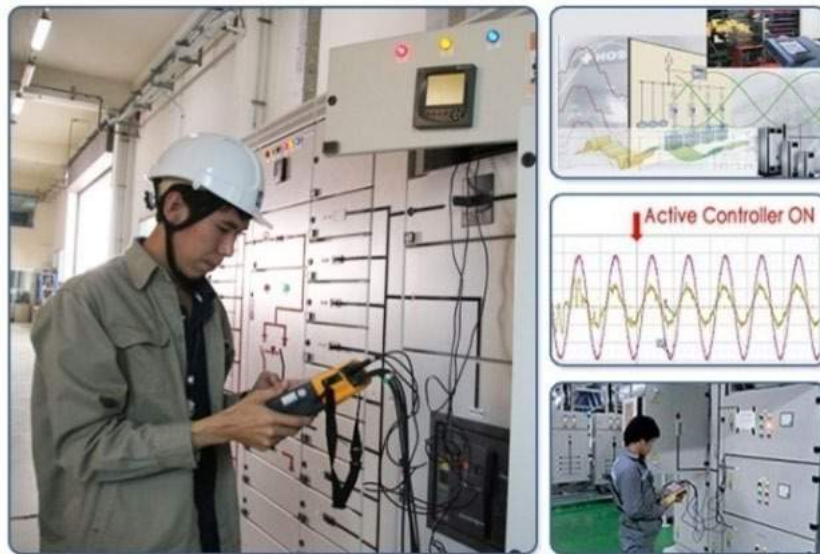
รูปที่ 3.11 การตรวจสอบ แก้ไขปรับปรุงคุณภาพไฟฟ้า
