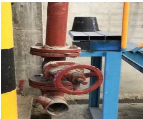
รูปที่ 4.7 การติดตั้งระบบท่อส่งน้ำดับเพลิง
