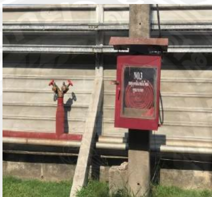
รูปที่ 4.11 ตู้เก็บสายฉีบน้ำดับเพลิง
