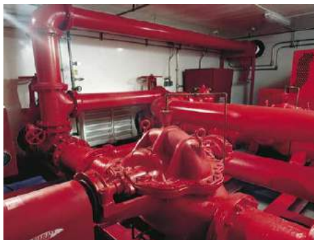
รูปที่ 2.11 การติดตั้งเครื่องสูบน้ำดับเพลิงแบบนอน
