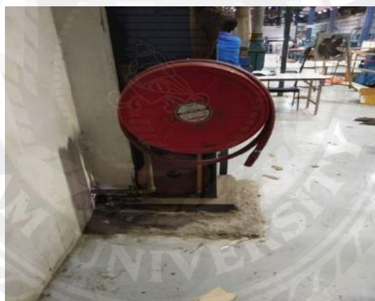
รูปภาพที่ 2.4 สายฉีดน้ำดับเพลิง
