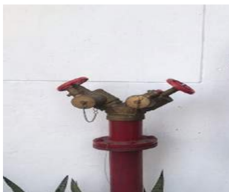
รูปที่ 4.8 หัวจ่ายน้ำดับเพลิง
