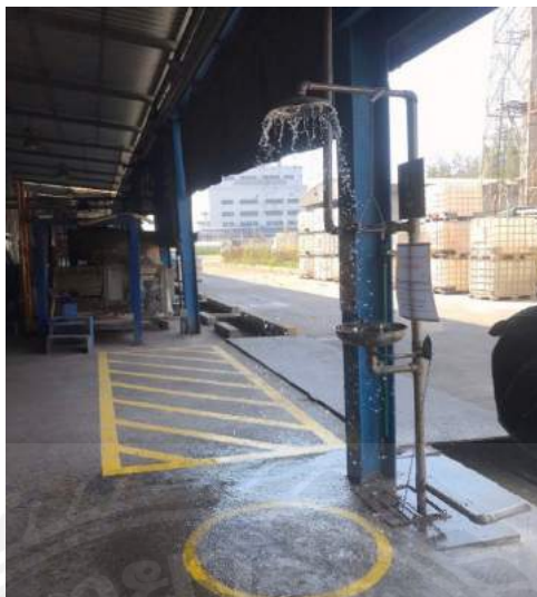
ทดสอบอัตราการไหลของฝักบัวพร้อมอ่างล้างตาฉุกเฉิน
