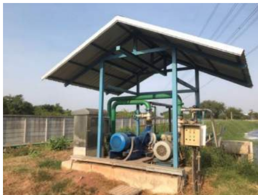
รูปที่ 4.3 ห้องเครื่องปั้มน้ำ
