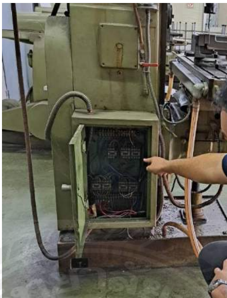
รูปที่ 3.8 ตู้ควบคุมเครื่องจักร
