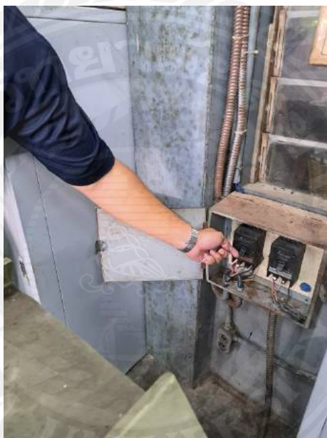
รูปที่ 3.5 ตู้ไฟฟ้าจ่ายกระแสเข้าเครื่องจักร
