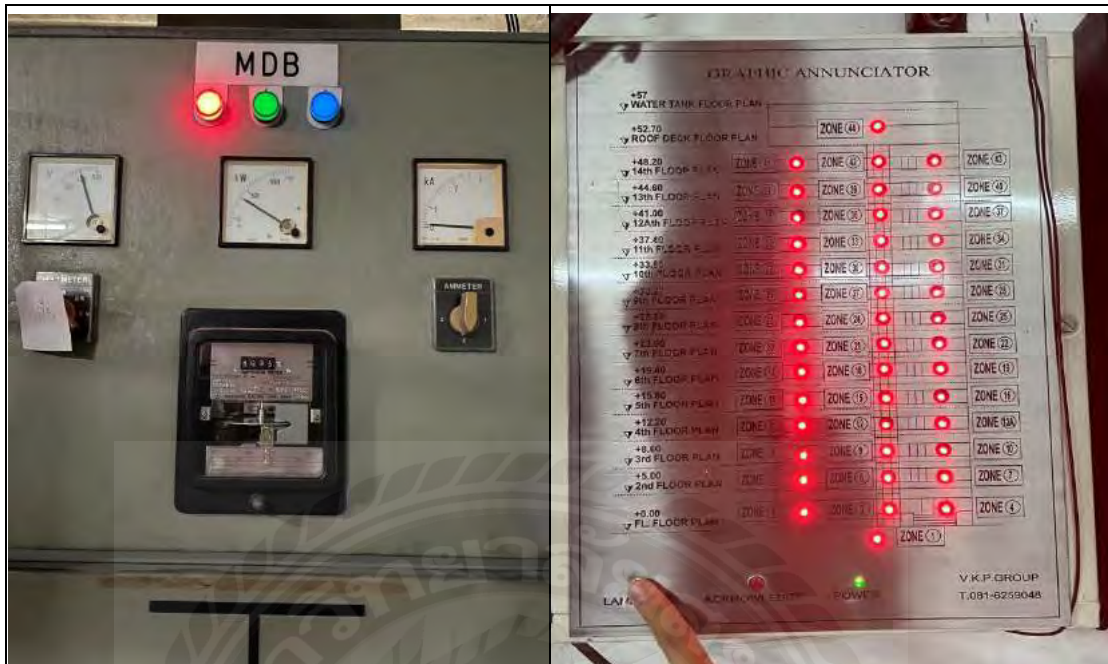
รูปภาพผนวก ที่ 43 แหล่งจ่ายไฟฟ้าให้แผงควบคุมมาจากตู้ MDB
