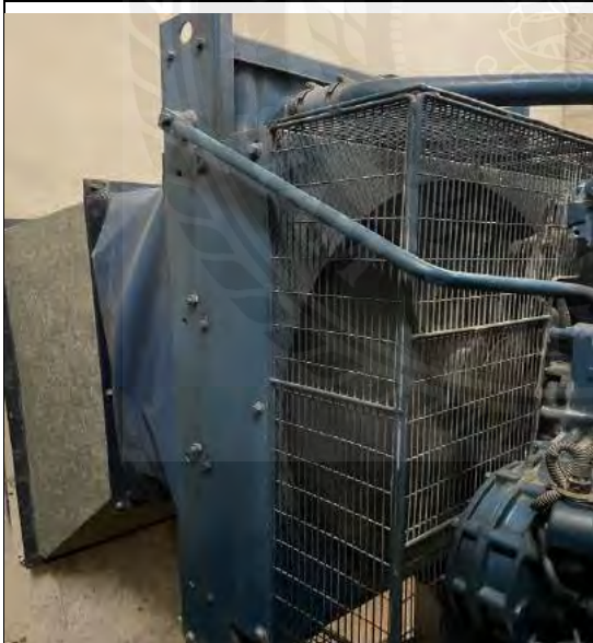
รูปภาพผนวก ที่ 35 ระบบระบายอากาศของเครื่องยนต์ขณะ ทำงานงานมีการระบายอากาศได้ปกติ
