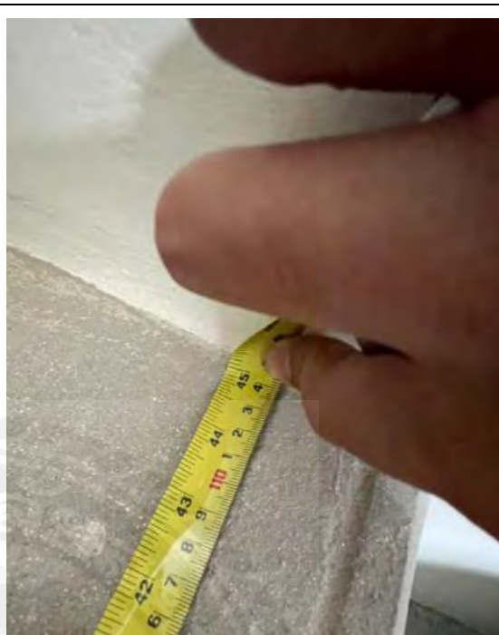
รูปภาพผนวก ที่ 9 วัดความกว้างบันไดที่ 1 ได้ 115 ซม.
