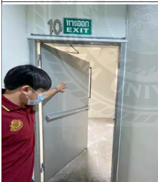
รูปภาพผนวก ที่ 3 อุปกรณ์บังคับปิดประตูใช้งานได้ปกติ
