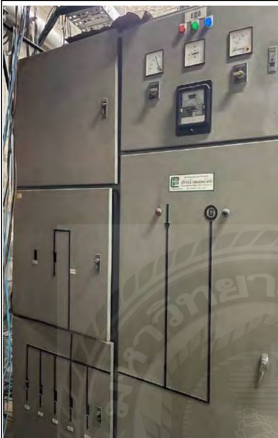
รูปภาพผนวก ที่ 37 วงจรระบบจ่ายไฟฟ้าวงจรระบบจ่ายไฟฟ้ามี การทำงานที่ปกติ
