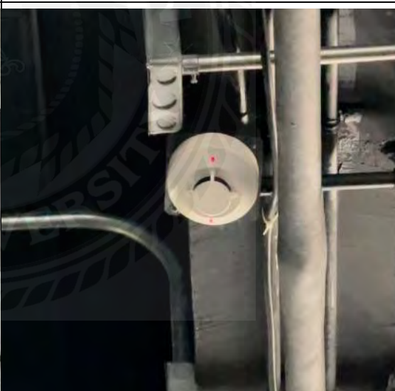
รูปภาพผนวก ที่ 42 อุปกรณ์กริ่งแจ้งเหตุแบบอัตโนมัติไฟกระพริบที่อุปกรณ์แสดงความพร้อมในการใช้งานอยู่ตลอดเวลาและแบบใช้มืออยู่ในสถานะพร้อมใช้งาน
