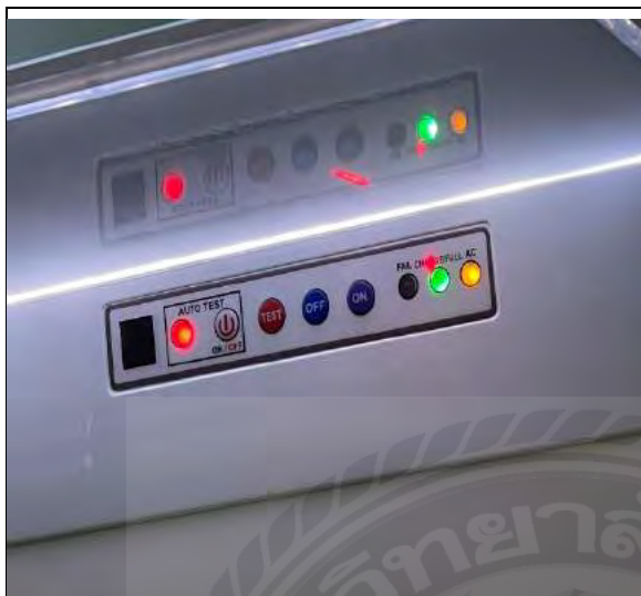
รูปภาพผนวก ที่ 23 มีแบตเตอรี่สำรองในไฟป้าย
