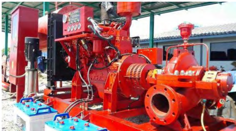
รูปที่ 3.12 เครื่องสูบน้ำดับเพลิง
