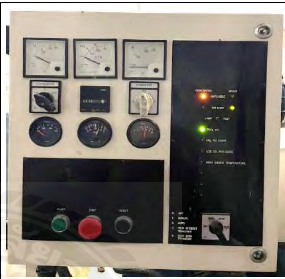
รูปภาพผนวก ที่ 34 เปิดเครื่องยนต์ระบบไฟฟ้าสำรอง ทั้งแบบ อัตโนมัติและแบบที่ใช้มือ มีการทำงานปกติดี
