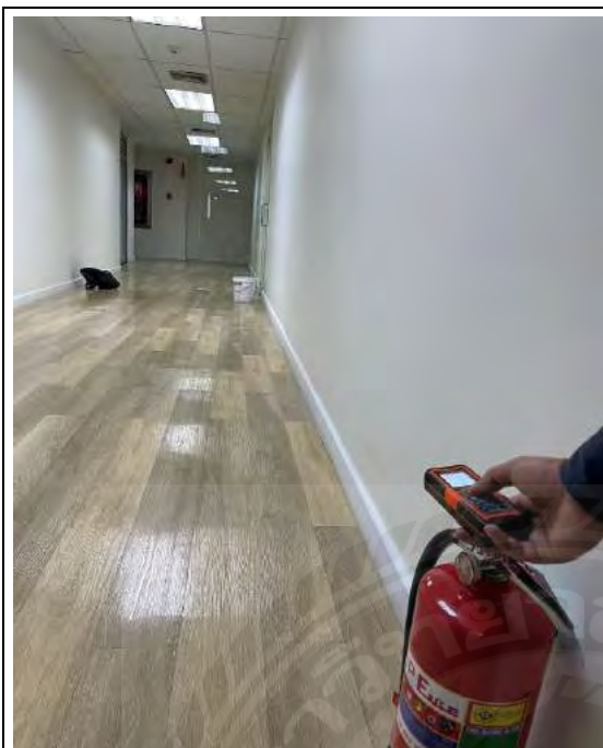
รูปภาพผนวก ที่ 50 วัดระยะห่างของถังดับเพลิง
