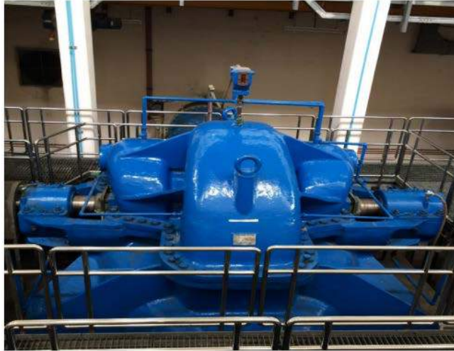
รูป 4.9 ปัมในระบบสูบน้ำประปา
