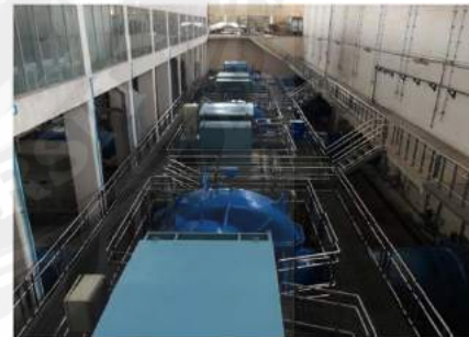
รูป 7 ระบบสูบน้ำจ่ายน้ำประปา
