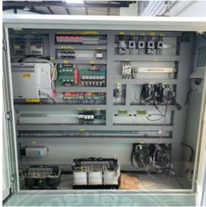
รูปภาคผนวก ข ที่ 11 แสดงถึงห้องควบคุมของเครื่องตัดท่ออัตโนมัติ
