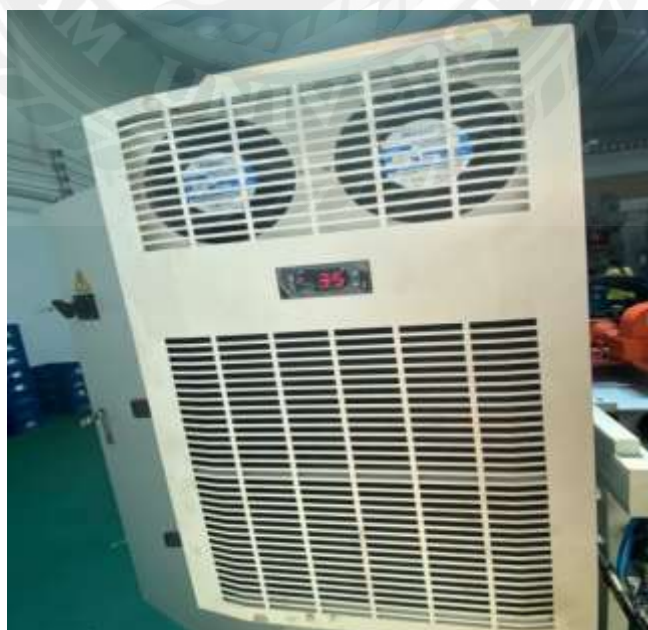
รูปภาคผนวก ข ที่ 10 แสดงถึงแอร์ควบคุมอุณหภูมิภายในเครื่องระบบระบายความร้อน
