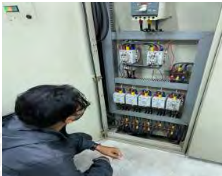
รูปที่ ๑ ตรวจสอบระบบไฟฟ้า
