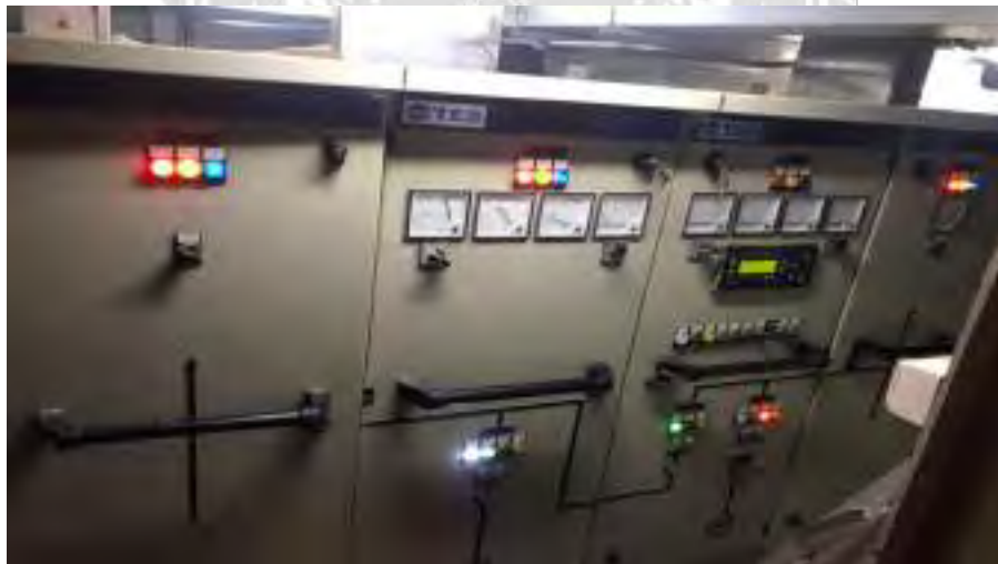
รูปที่ 2.1 Main switchboard
