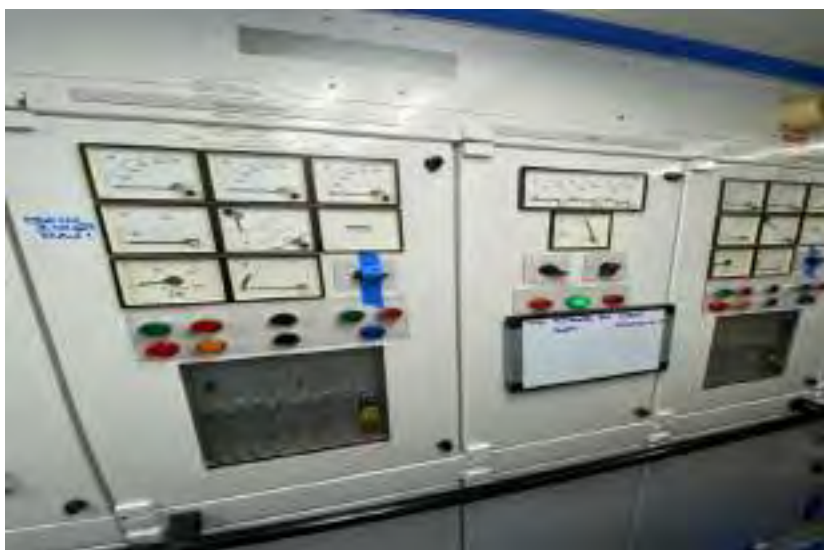
รูปที่ 2.2 ตู้คอนโทรล Generator
