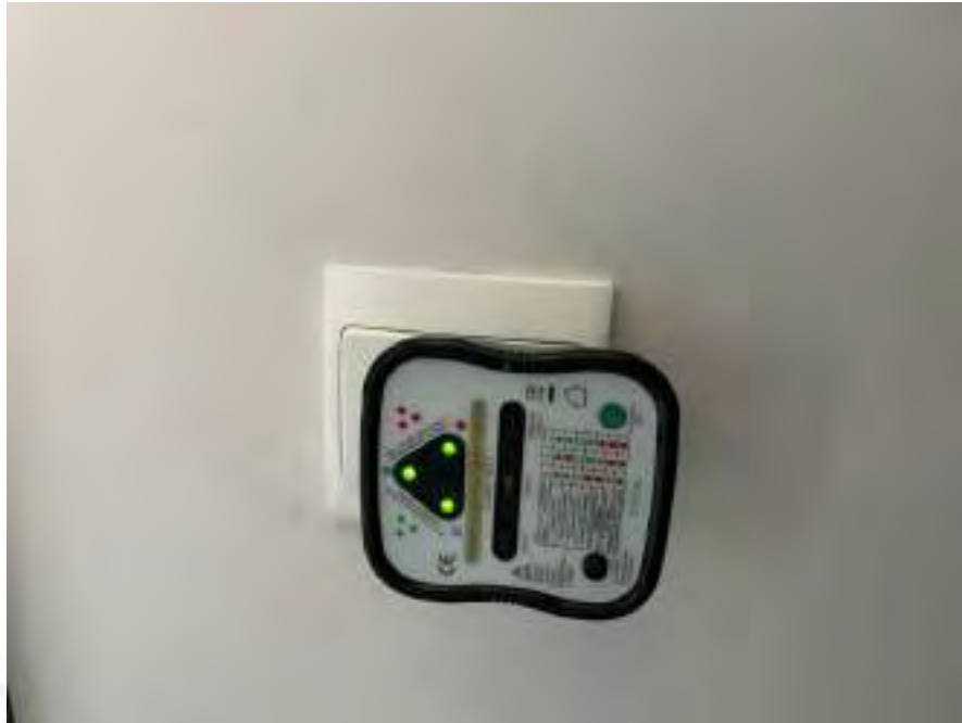
รูปที่ 4.36 ตรวจสอบระดับแรงไฟฟ้าของเต้ารับ
