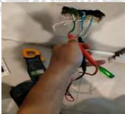
รูปที่ 4.15 ตรวจสอบสายไฟที่มาจากตู้เบรกเกอร์
