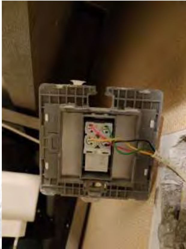
รูปที่ 4.27 การเข้าสายที่ตัวอุปกรณ์
