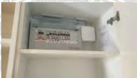
รูปที่ 4.32 การตรวจสอบความเรียบร้อยของตู้เบรกเกอร์
