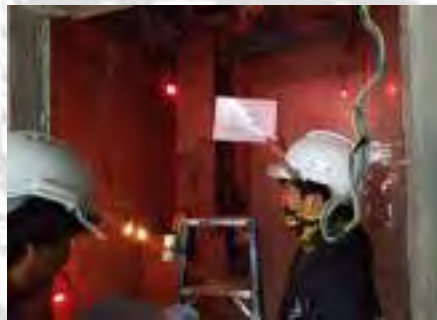
รูปที่ 4.17 ทดสอบแรงดันไฟฟ้าเต้ารับในห้องน้ำ
