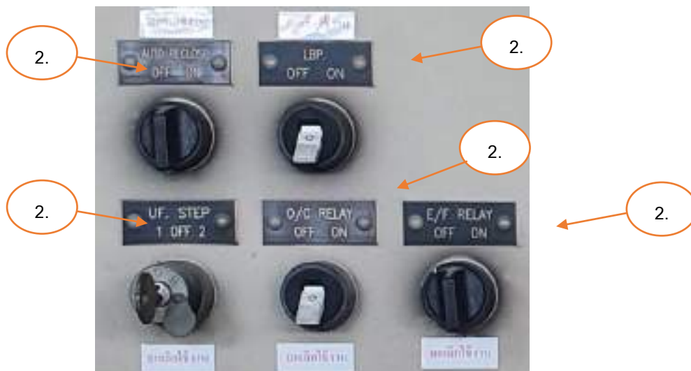
รูปที่ 2.19 สวิตช์ควบคุมรีเลย์ทางด้าน แรงดันกลาง รวมถึง การใช้งานของวงจร LBP (ปัจจุบัน ยกเลิกการใช้งาน นำเข้าระบบ SA/CSCS แทน)
