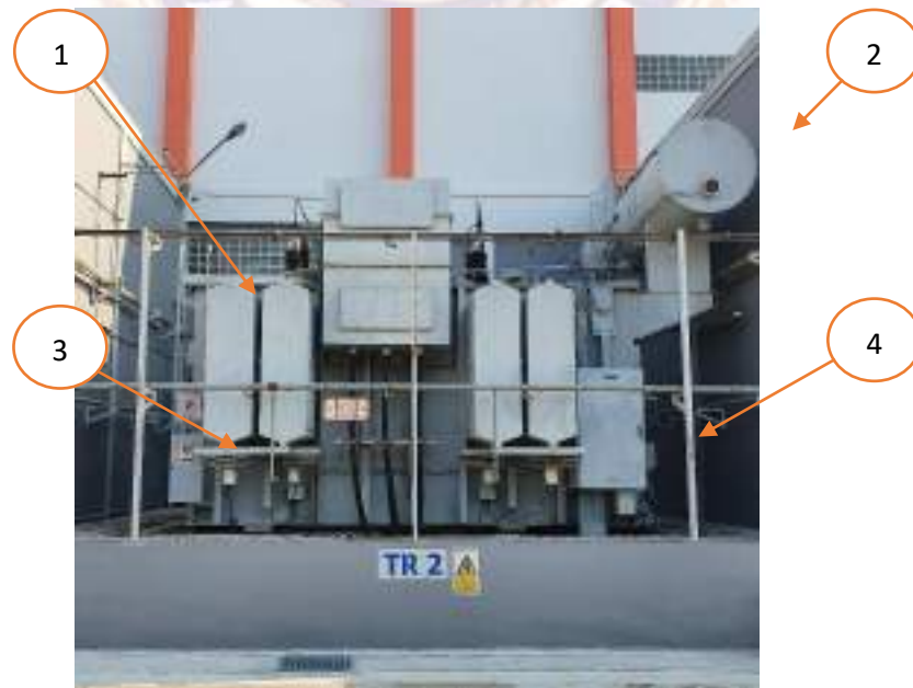
รูปที่ 2.28 หม้อแปลงไฟฟ้า TR2 (ภาพด้านหน้า)
