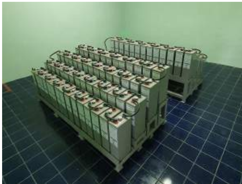
รูปที่ 2.45 แบตเตอรี่ ยี่ห้อ SUNLIGHT ภายในห้อง BATTERY
