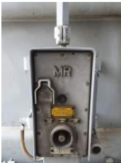
รูปที่ 2.31 ชุดแท่นการเลือกจ่ายด้านแรงดันไฟฟ้า 12/24 kV
