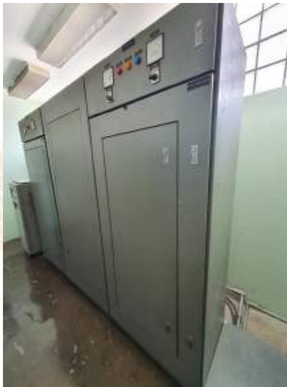
รูปที่ 2.35 ตู้ AC/DC Panel ของ สถานีไฟฟ้า
