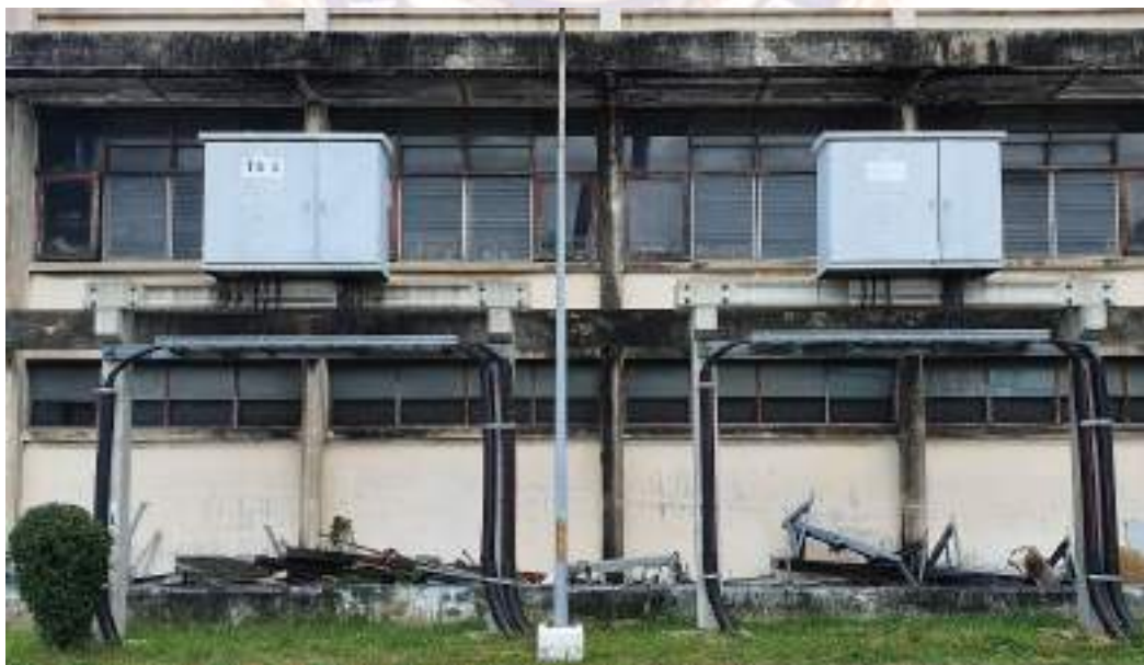
รูปที่ 2.40 หม้อแปลง Pad mounted ( TS1 และ TS2 )
