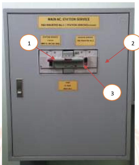
รูปที่ 2.34 ตู้ MCB Selector เลือกรับไฟจ่ายภายในสถานี
