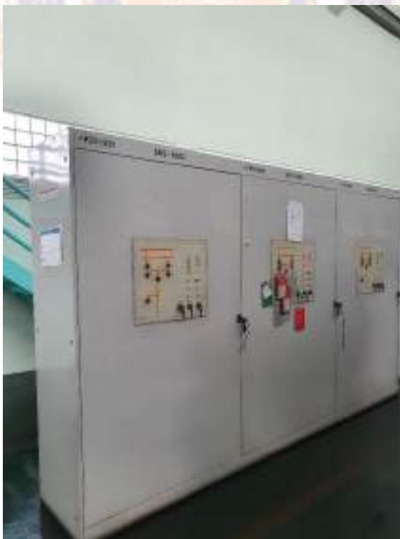
รูปที่ 2.7 อุปกรณ์สวิตช์เกียร์ไฟฟ้าแรงสูง (ตู้ควบคุมแบบ LOCAL)
