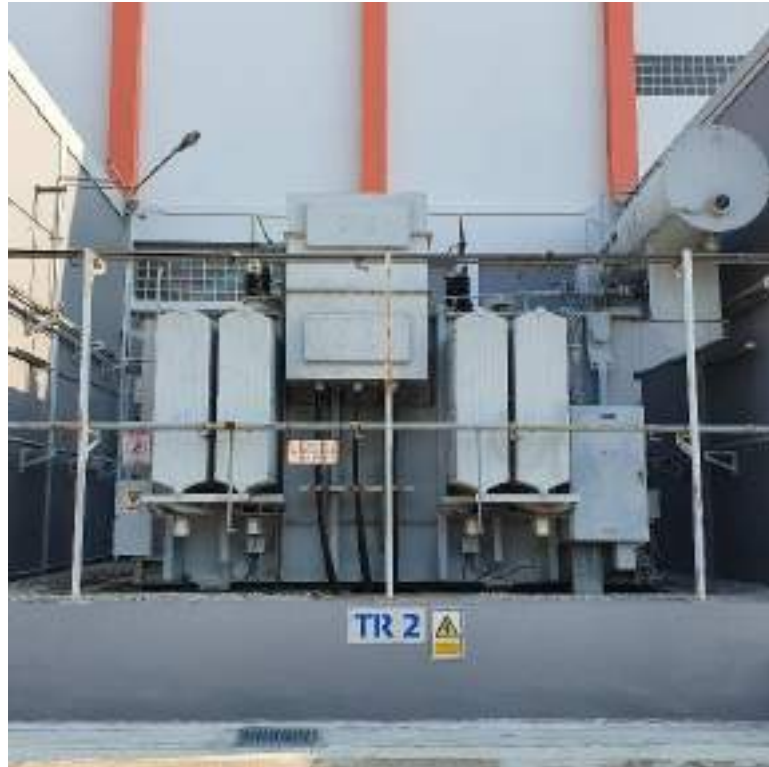
รูปที่ 2.27 หม้อกำลังแปลงไฟฟ้า
