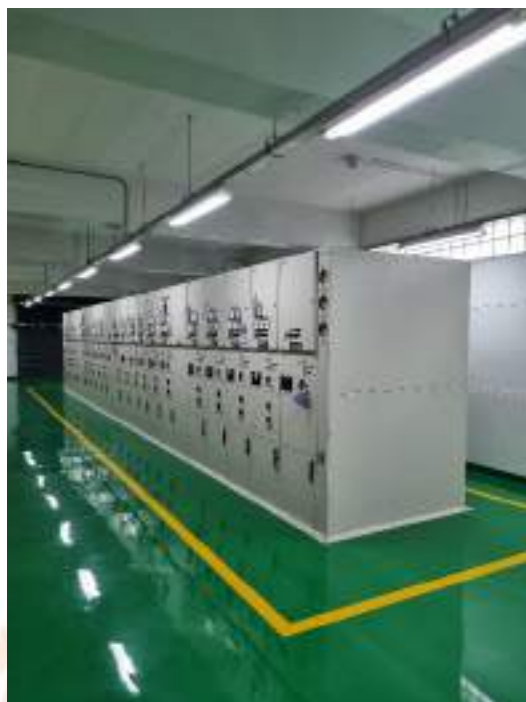
รูปที่ 3 Switch Gear 24 kV
