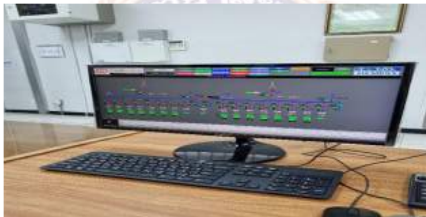
รูปที่ 4.3 เครื่องคอมพิวเตอร์ที่ใช้ควบคุมอุปกรณ์และตรวจสอบสถานะแจ้งเตือนของอุปกรณ์
