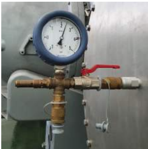
รูปที่ 2.6 จุดเติมก๊าซ SF_6 และ มาตรวัดความดันของก๊าซ SF_6
