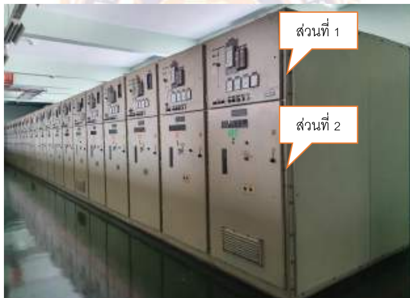
รูปที่ 2.15 อุปกรณ์สวิตช์เกียร์แรงดันปานกลางแบบ Metal Clad
