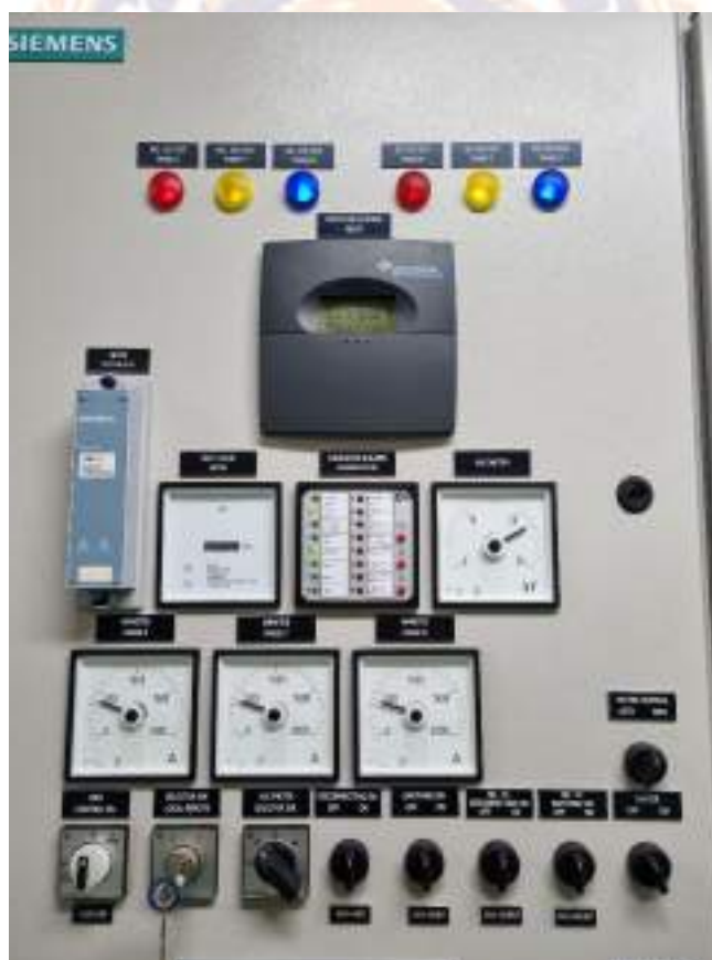
รูปที่ 2 แผงควบคุมตู้ Switch Gear 24 kV
