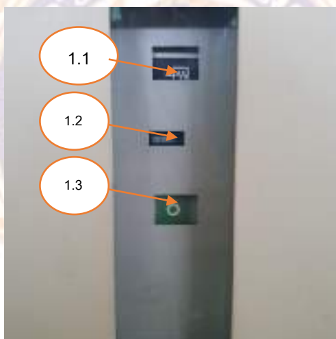
รูปที่ 2.26 อินดิเคเตอร์ของเซอร์กิตเบรกเกอร์ภายในตู้
