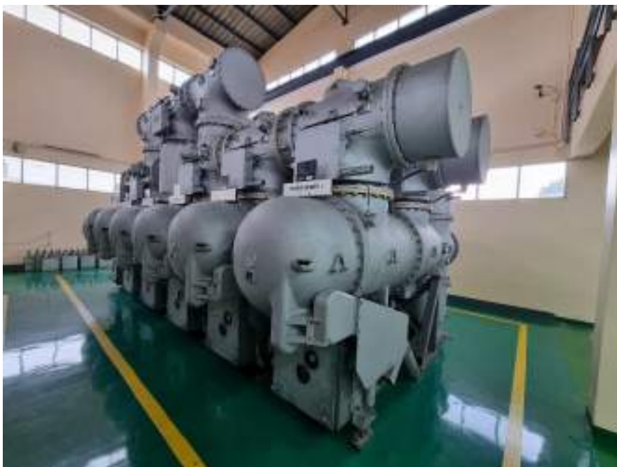
รูปที่ 1 Switch Gear 69 kV
