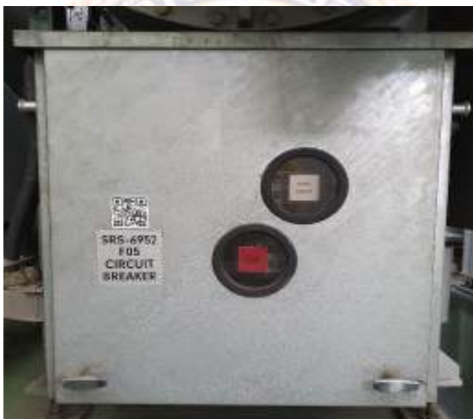
รูปที่ 2.3 สถานะของเซอร์กิตเบรกเกอร์ และการประจุสปริงมอเตอร์
