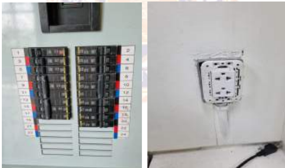
รูปที่ 4.6 ตู้เซอร์กิตเบรกเกอร์ และเต้ารับภายในห้องควบคุม
