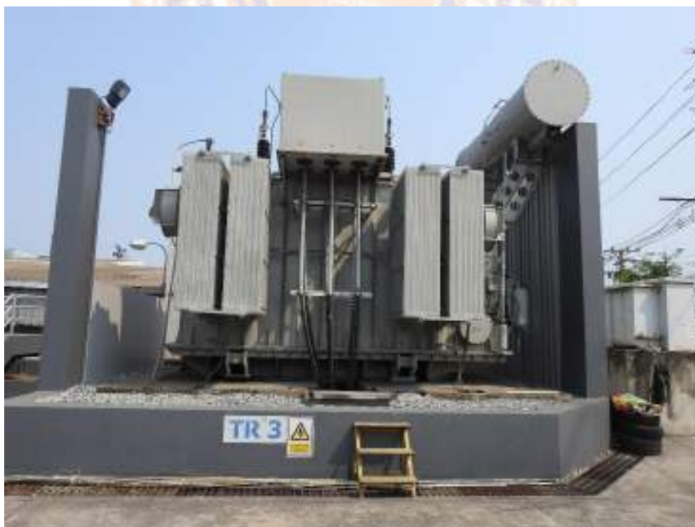
รูปที่ 4 Power Transformer 30 kVA
