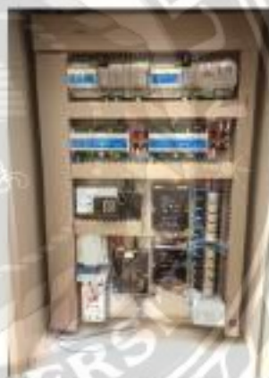
ตู้คอนโทรลแสงสว่างฉุกเฉินทั้งโครงการ
