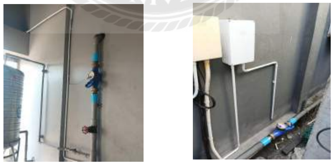
รูปที่ 2.5 ตำแหน่งการติดตั้งมิเตอร์
