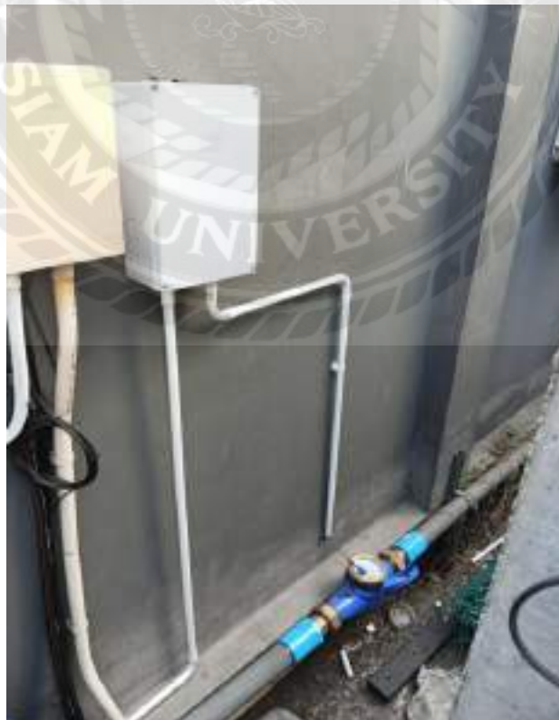
รูปที่ 4.1 การติดตั้งมิเตอร์น้ำแบบพัลส์ในสถานที่ต่างๆ
