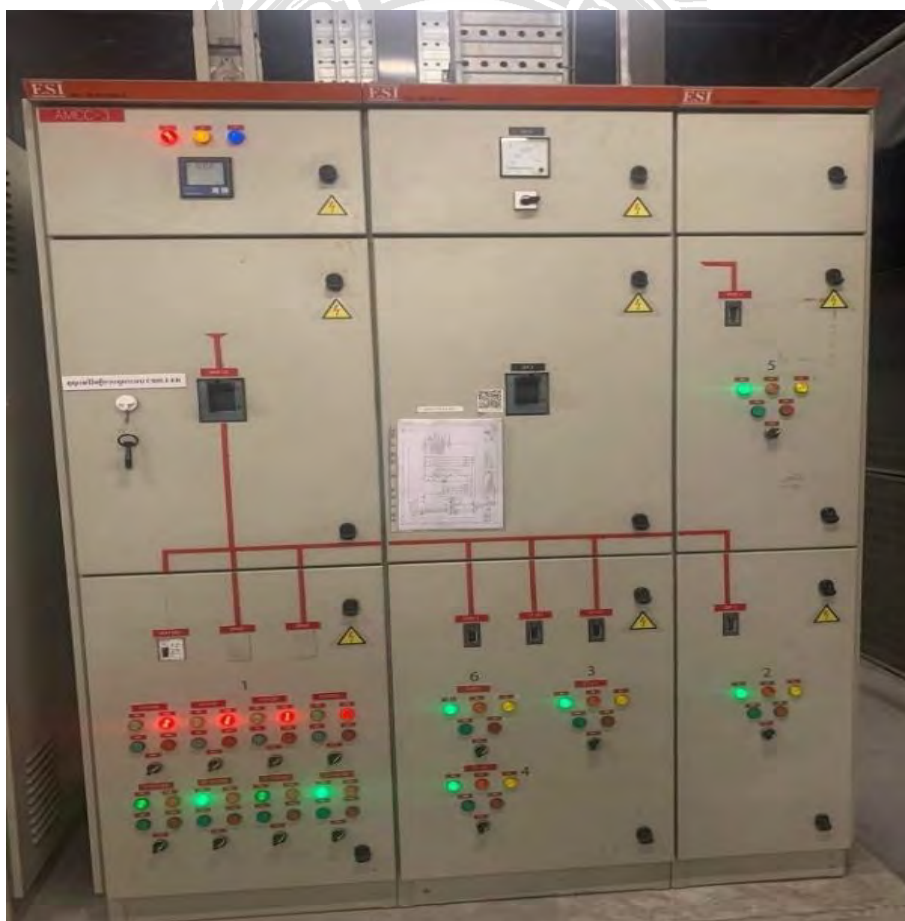
รูปที่ 4.2.1 ตู้ควบคุมไฟฟ้า (AMCC)
