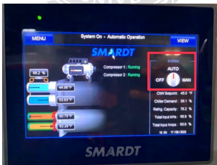
รูปที่ 4.2.4 หน้าจอ Chiller
