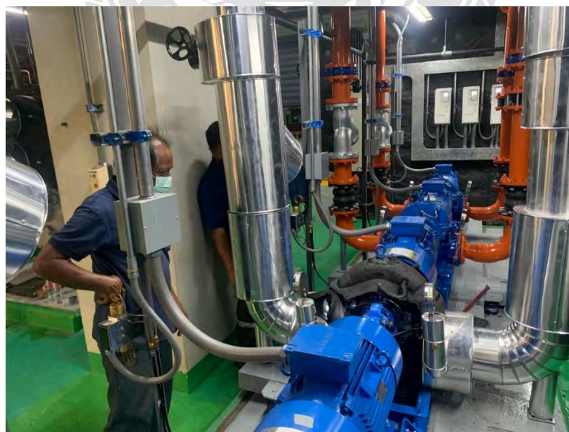
รูปที่ 4 ตรวจสอบการทำงานของปั๊ม เนื่องจากมีน้ำรั่ว
