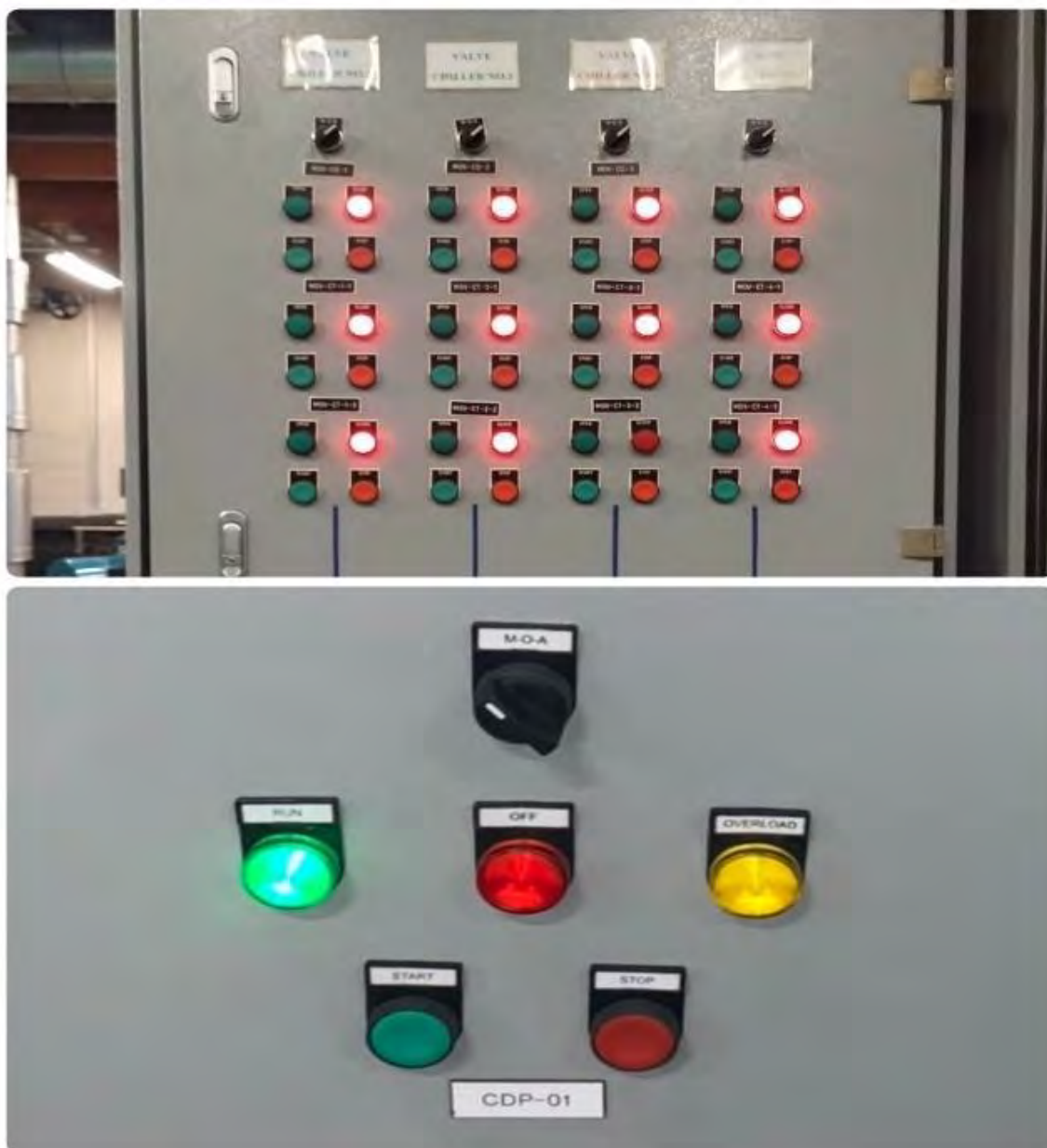
รูปที่ 4.2.2 ตู้ควบคุม Valve
