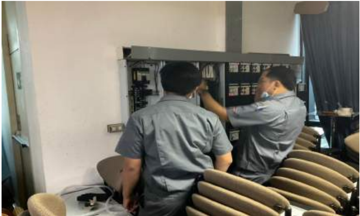
รูปที่ 22 แก๊วระบบตู้วงจรย่อยควบคุมระบบไฟฟ้า
