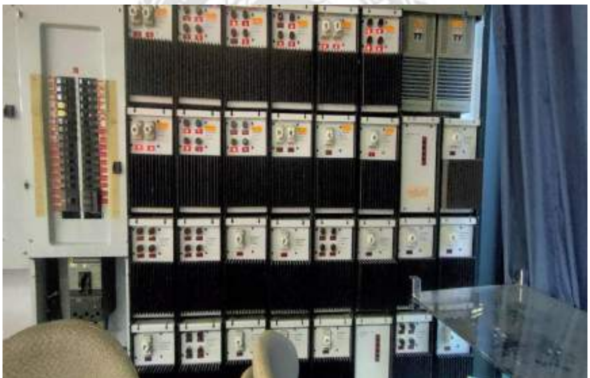
รูปที่ 23 เซ็คตู้วงจรย่อยควบคุมระบบแสงสว่าง
