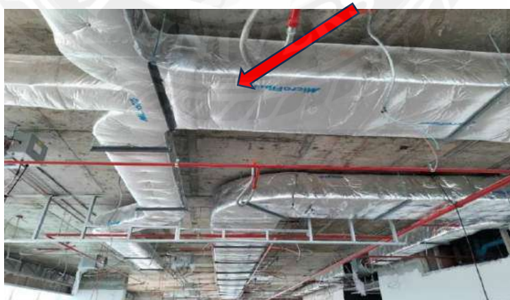
รูปที่ 2.1 ท่อส่งลมเย็น
