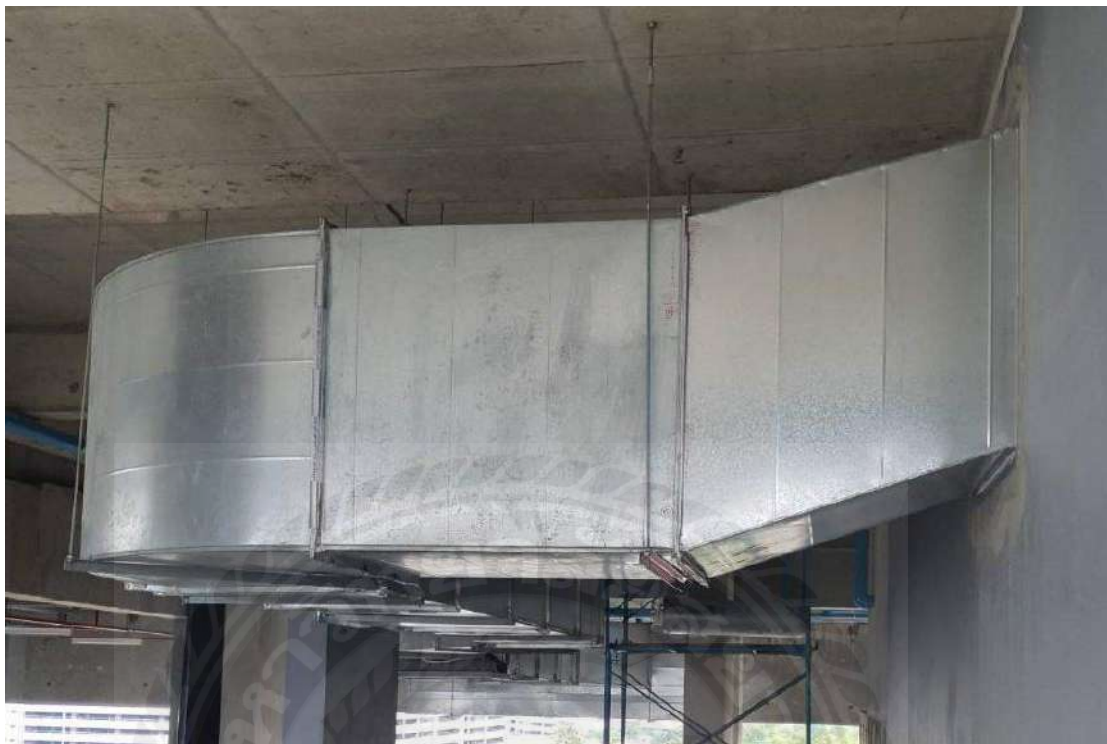
รูปที่ ข.3 ท่อลมอัดอากาศ
