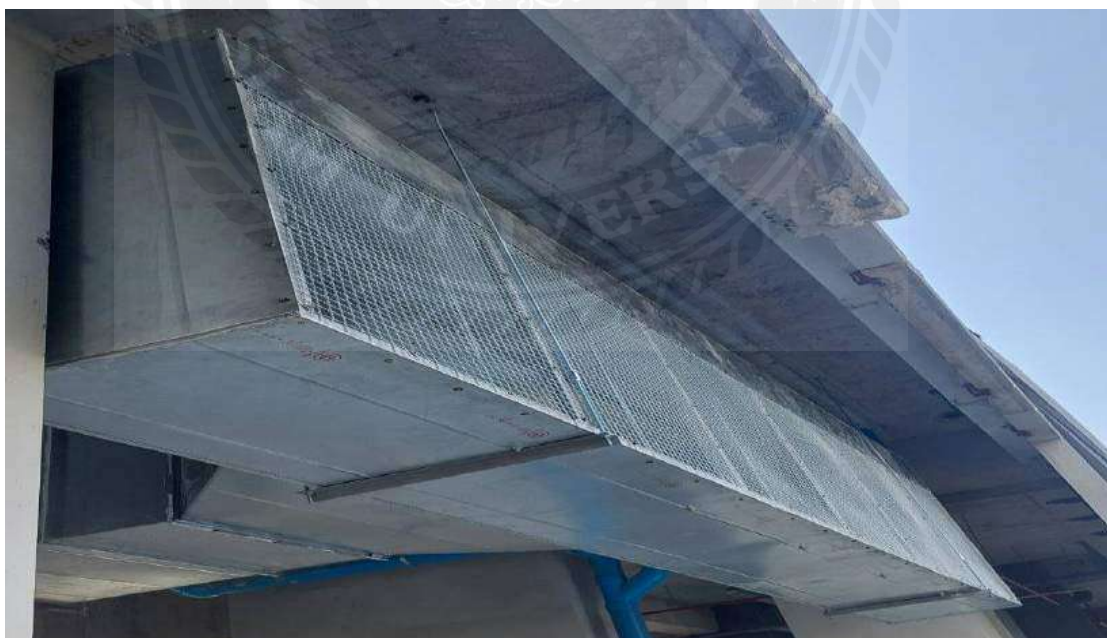
รูปที่ ข.4 ท่อลมอัดอากาศ
