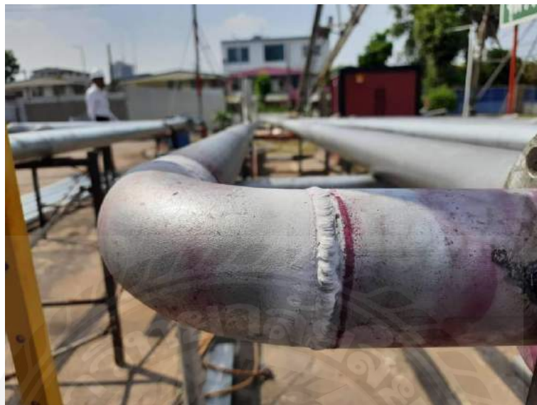
รูปที่ 3.11 พื้นผิวชิ้นงานสะอาดเรียบร้อยแล้ว ใช้สเปรย์ Mega Check Developer ทาปฏิกิริยา และ ตรวจสอบข้อบกพร่อง
