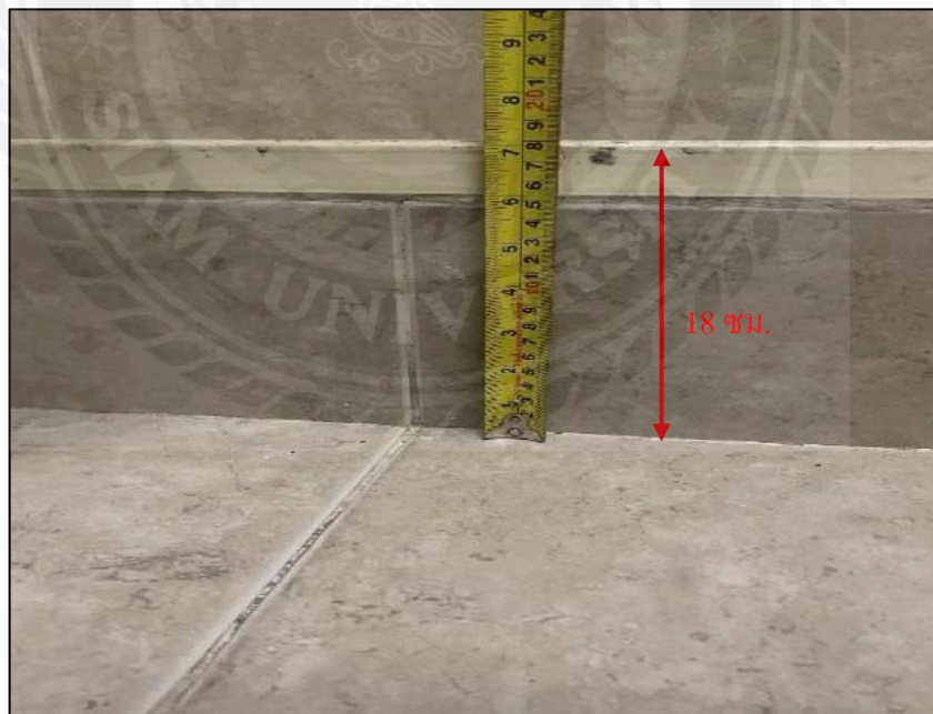
รูปที่ 3.19 ลูกตั้งบันไดวัดได้ 18 ซม.
