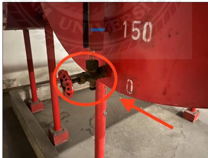
รูปที่ 3.7 วาล์ว ของ Oil Tank
