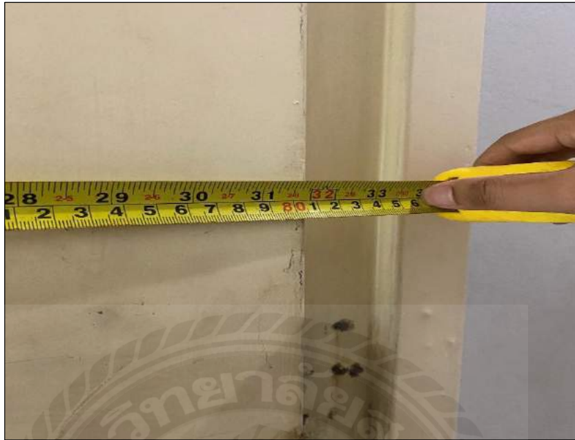
รูปที่ 3.28 ความกว้างประตูหนีไฟวัดได้ 80 ซม.
