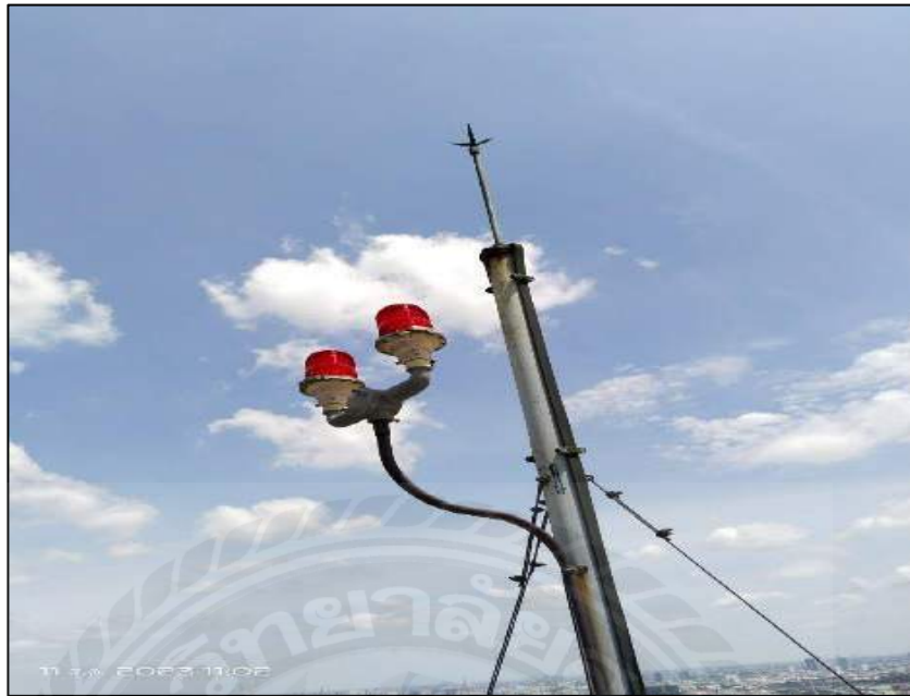
รูปที่ 3.32 ตรวจสอบระบบตัวนำต่อฟ้า
