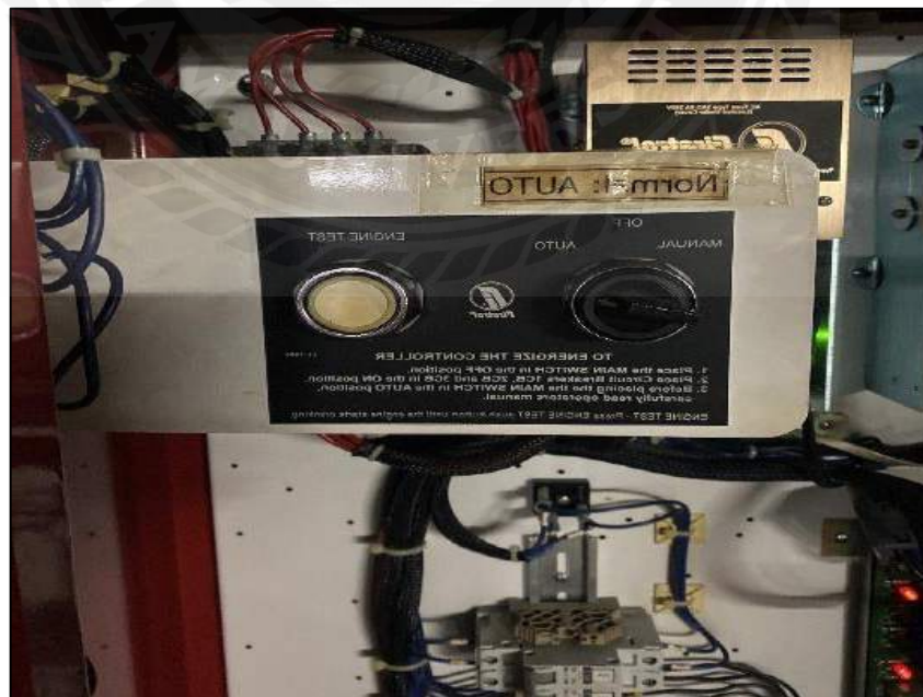
รูปที่ 3.11 ตู้ Selector Switch Control Fire Pump
