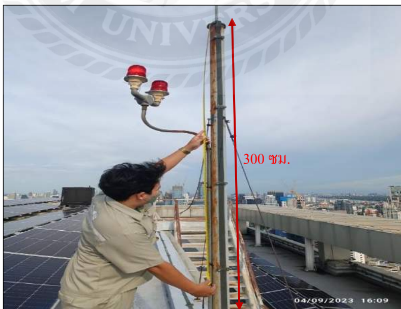
รูปที่ 3.31 ตรวจสอบระบบตัวนำล่อฟ้า สูง 300 ซม.
