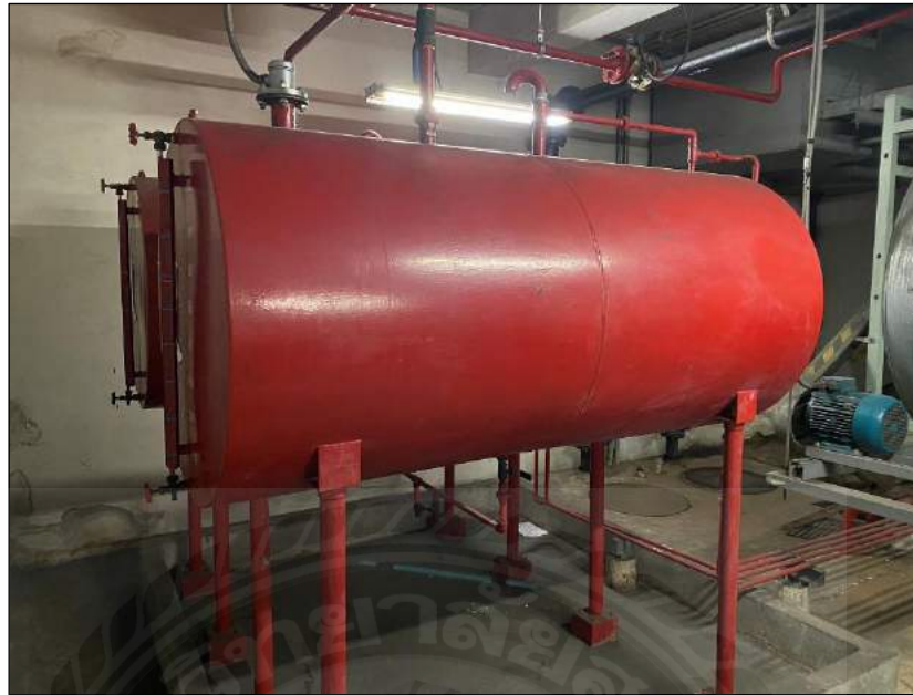
รูปที่ 3.6 Oil Tank
