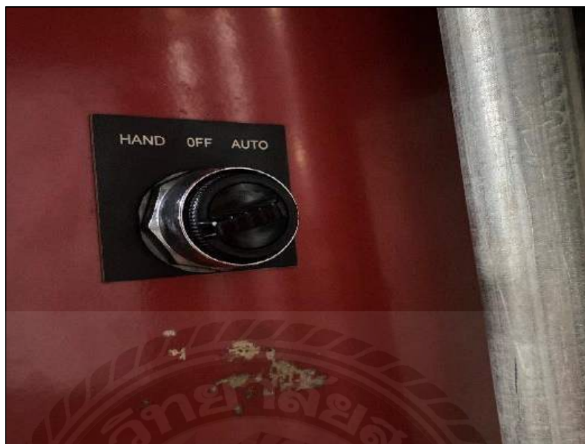
รูปที่ 3.12 Circuit Breaker ของ Control Jockey Pump
