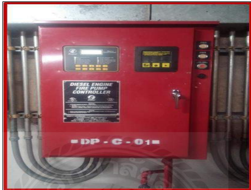
รูปที่ 3.10 ตู้ Control Fire Pump
