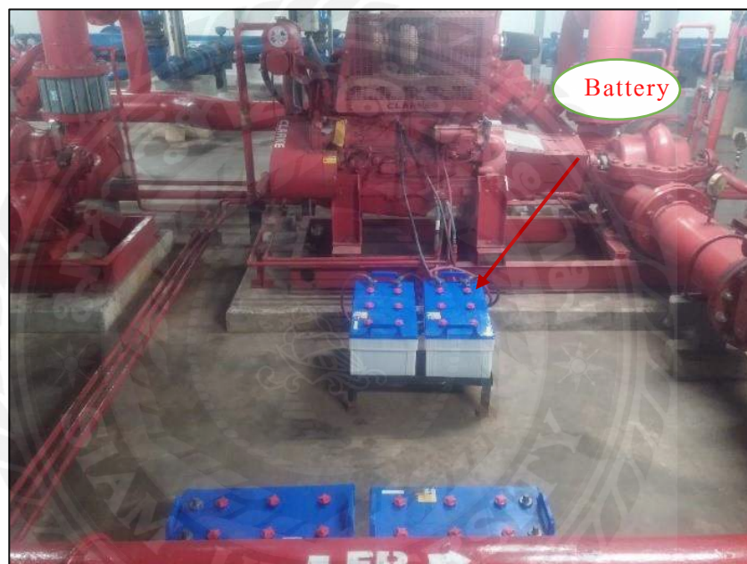
รูปที่ 3.8 Battery Fire Pump
