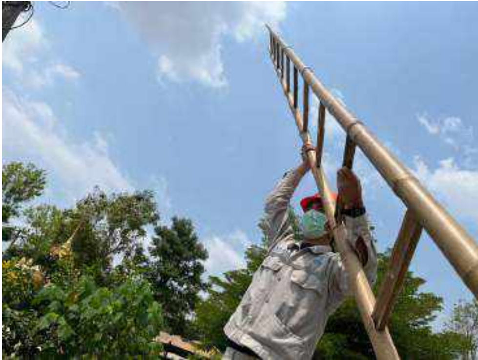
รูปที่ 3.18 ถึงหน้างานดำเนินการหาเหตุขัดข้องโดยการขึ้นตรวจสอบที่ตู้แยกสัญญาณ
