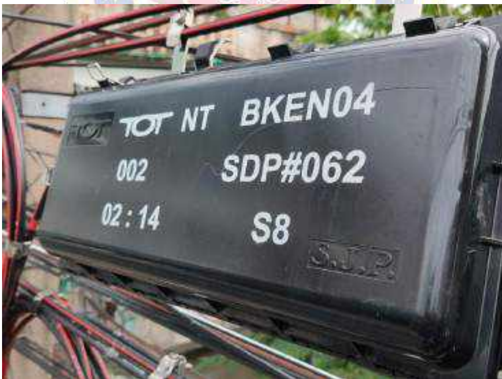
รูปที่ 3.19 ตู้แยกสัญญาณ SDP (Splitter Distribution Point)
